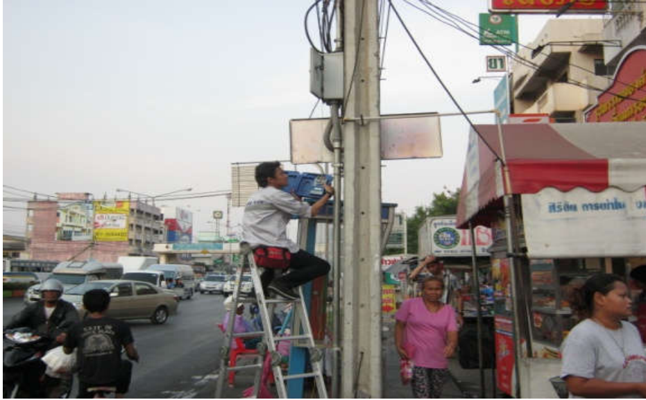
รูปที่ 4.20 การวัดค่ากราวด์ตู้สวิตซ์ตัดตอนบนบอคอดิน
