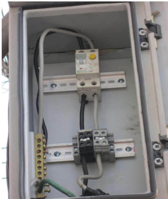
รูปที่ 4.12 สวิทช์ตัดตอน
