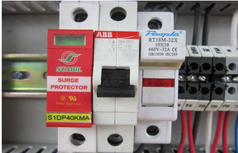
รูปที่ 4.11 อุปกรณ์ป้องกันไฟฟ้า
