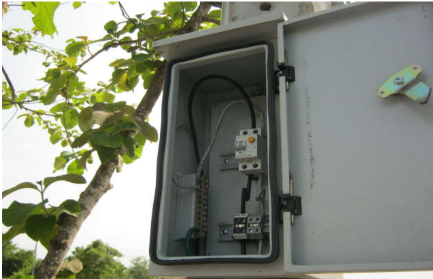
รูปที่ 4.14 การต่อสายดินในตู้สวิตช์ตัดตอน
