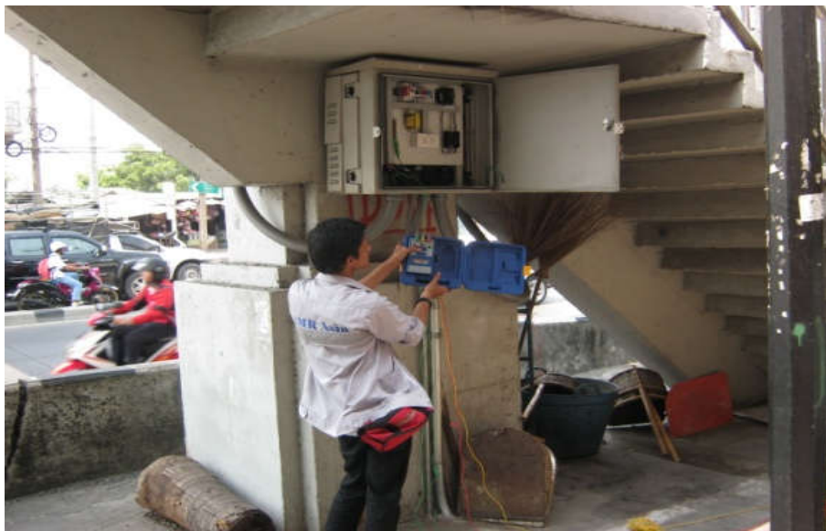
รูปที่ 4.16 การวัดค่ากราวด์ตู้ DVR บนสะพานลอย
