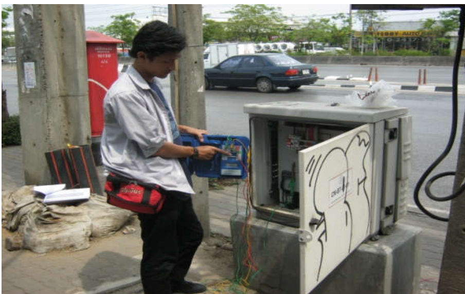
รูปที่ 4.17 การวัดค่ากราวด์ตู้ DVR บนคอดิน
