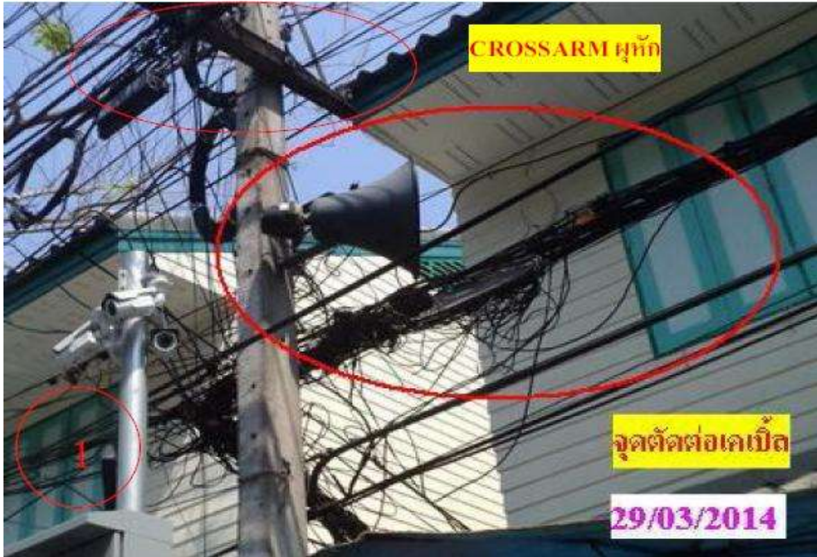
รูปก่อนทำงาน CROSSARM ผุ จุด 1
