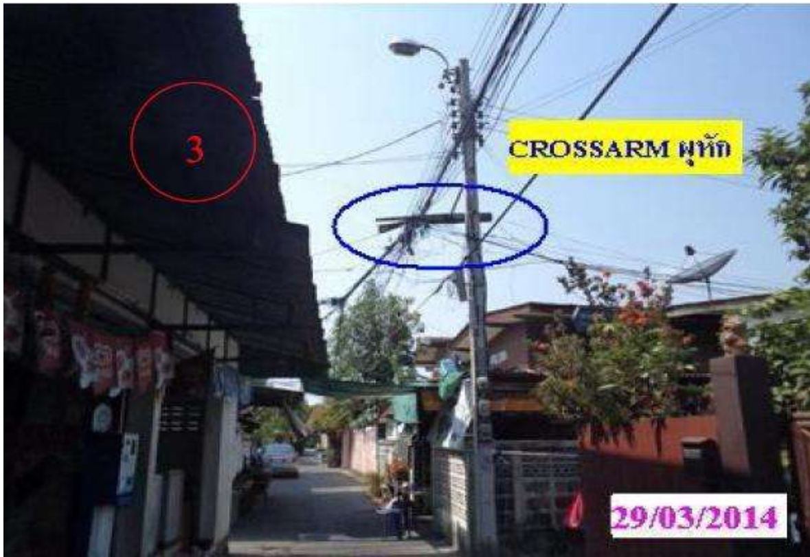
รูปก่อนทำงาน CROSSARM ผุ จุด 3
