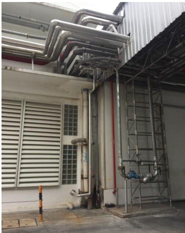
รูปที่ 4.17 การนำคอนเดนเสทกลับมาใช้ใหม่ จุดที่ 7
