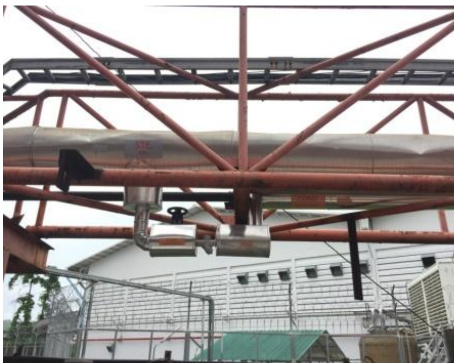
รูปที่ 4.14 การนำคอนเดนเสทกลับมาใช้ใหม่ จุดที่ 1
