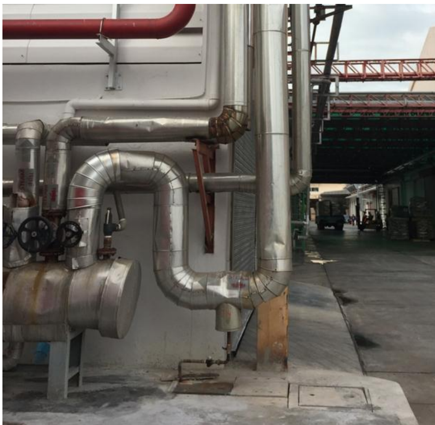
รูปที่ 4.6 การปล่อยคอนเดนเสทที่ จุดที่ 9
