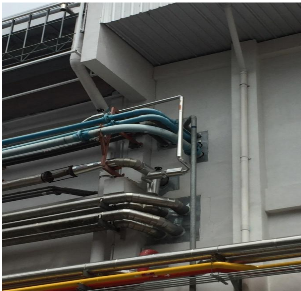
รูปที่ 4.23 การนำคอนเดนเสทกลับมาใช้ใหม่ จุดที่ 15
