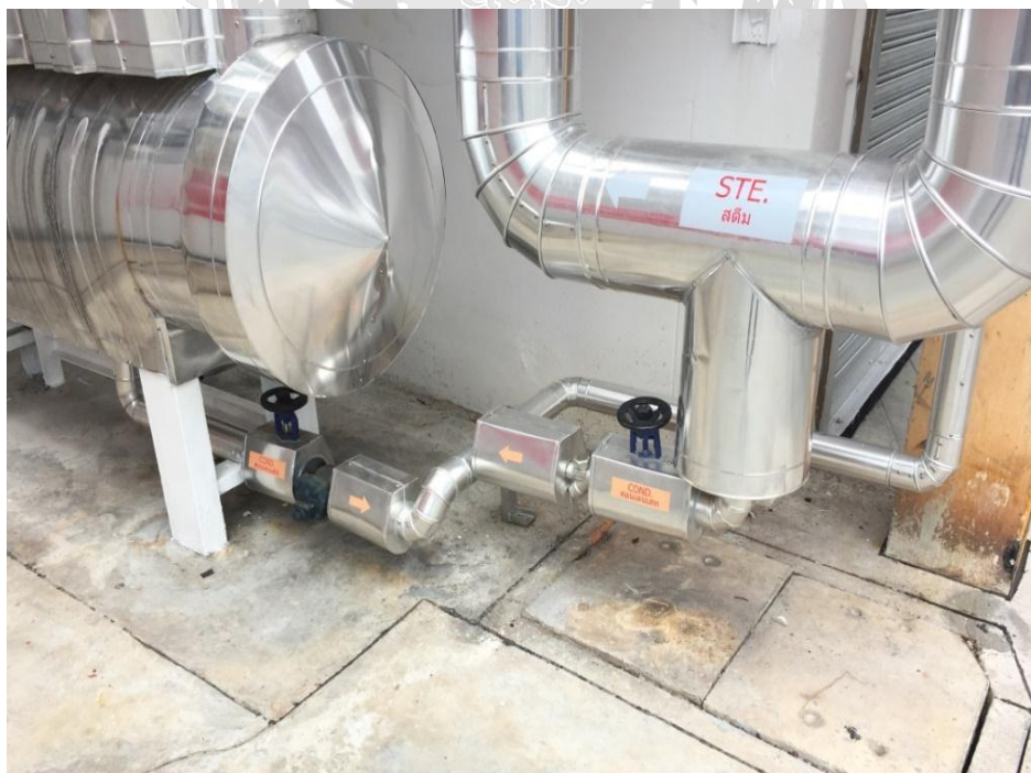
รูปที่ 4.20 การนำคอนเดนเสทกลับมาใช้ใหม่ จุดที่ 10
