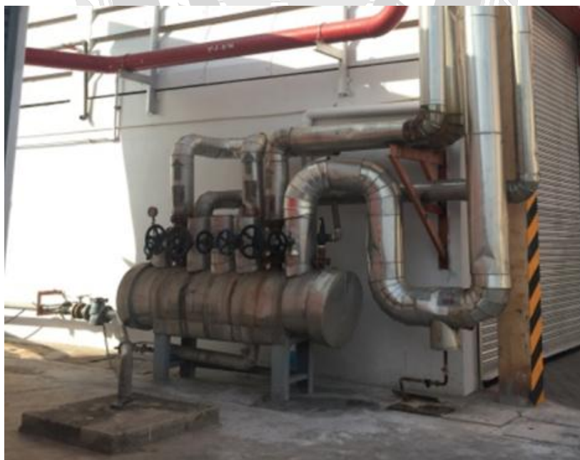
รูปที่ 4.12 ท่อส่งไอน้ำที่ฉนวนกันความร้อนชำรุด จุดที่ 2
