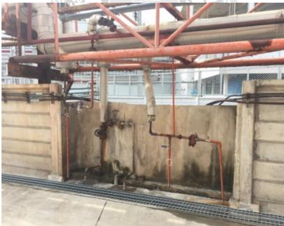
รูปที่ 4.3 การปล่อยคอนเดนเสททั้ง จุดที่ 4,5 และ 6
