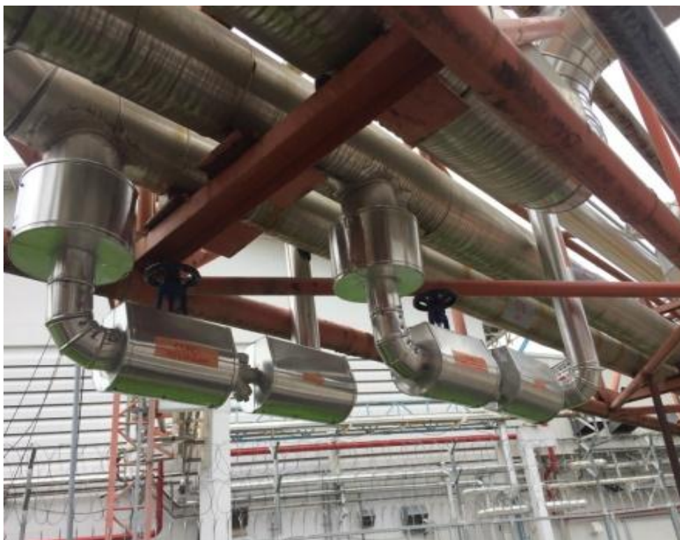
รูปที่ 4.15 การนำคอนเดนเสทกลับมาใช้ใหม่ จุดที่ 2,3
