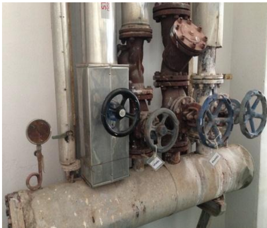
รูปที่ 4.13 ท่อส่งไอน้ำที่คำนวณกันความร้อนชำรุด จุดที่ 3
