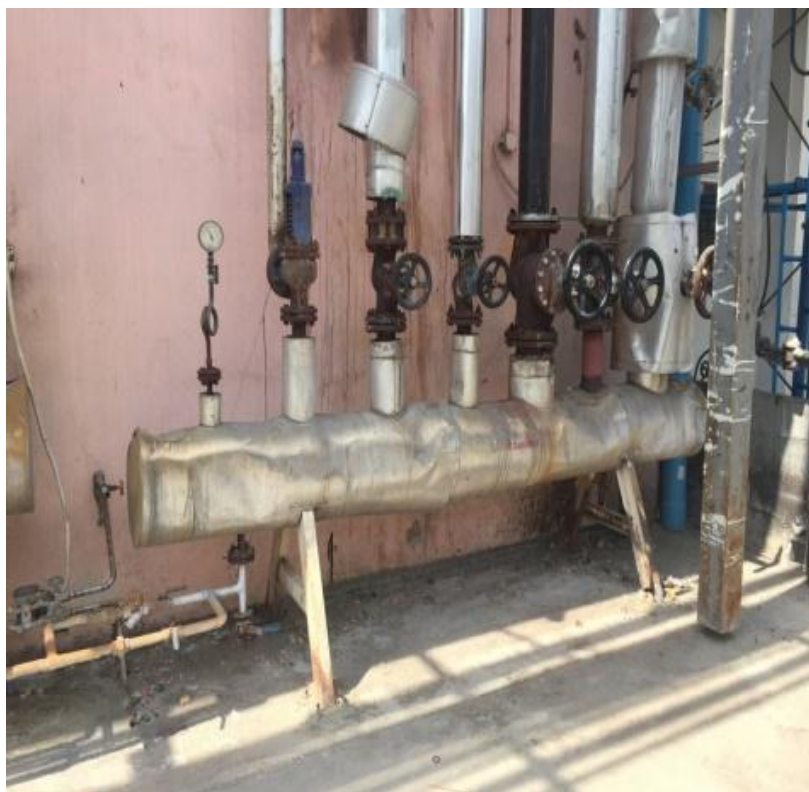
รูปที่ 4.11 ท่อส่งไอน้ำที่ฉนวนกันความร้อนชำรุด จุดที่ 1
