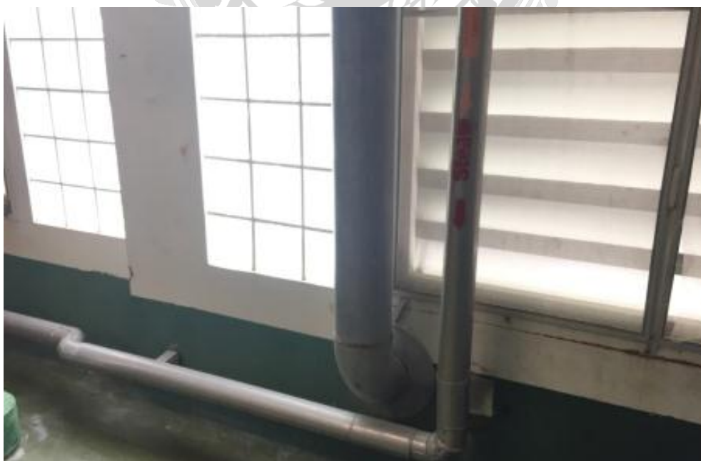
รูปที่ 4.18 การนำคอนเดนเสทกลับมาใช้ใหม่ จุดที่ 8
