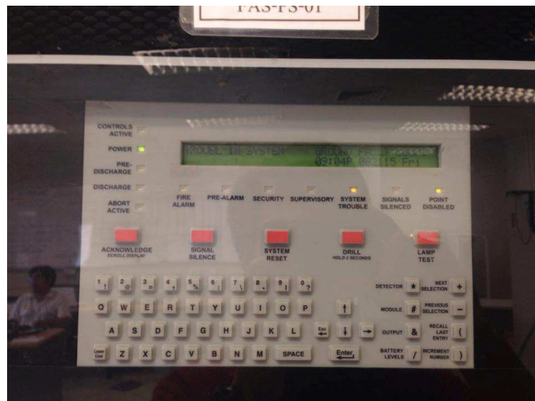
รูปที่ 3.11 รีเซ็ตค่าของหัวดักจับควัน (Smoke Detector) ที่ตู้ Controlor
