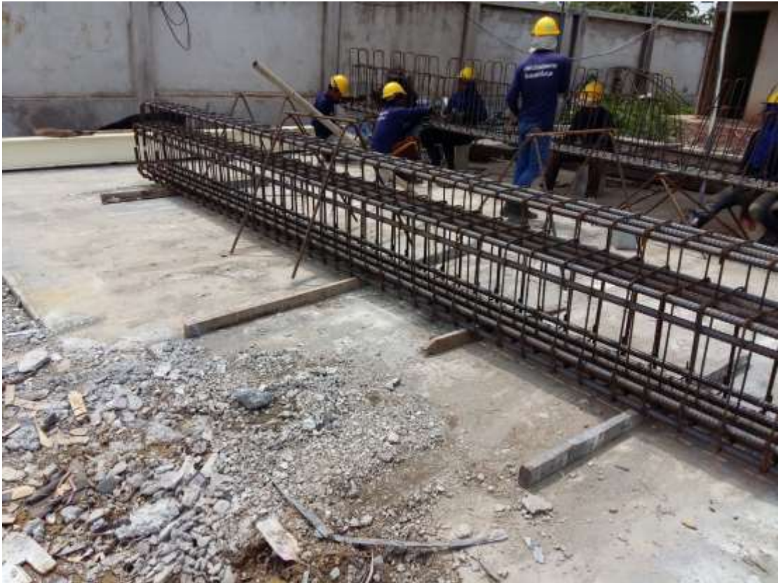
รูปที่ 4.20 ผูกเหล็กโครงสร้างของคาน Precast
