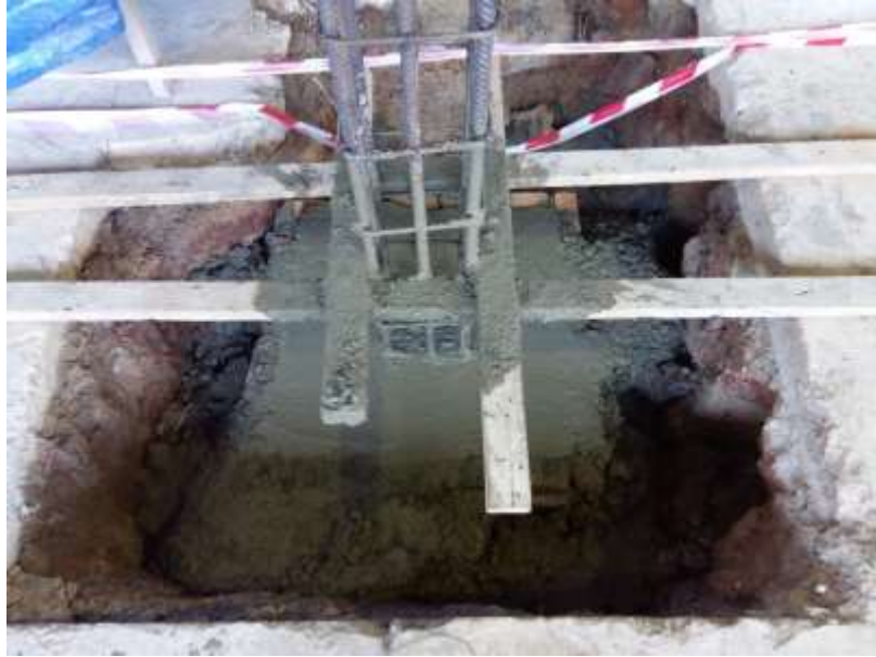
รูปที่ 4.9 ลักษณะของฐานรากหลังจากการเทคอนกรีต
