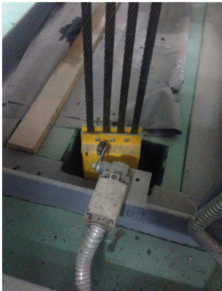
รูปที่ ก.4 ชุดควบคุมรวมเร็ว (Overner)
