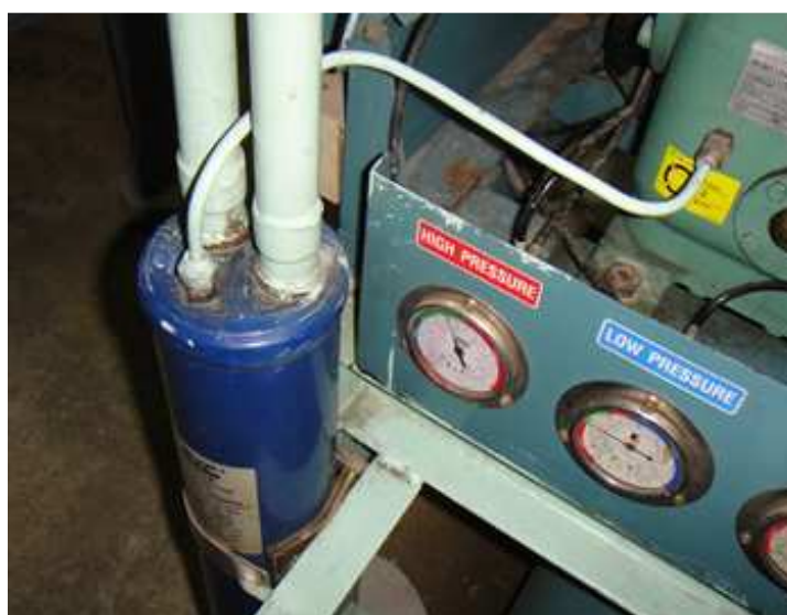
รูปที่ 2.13 อุปกรณ์แยกน้ำมันหล่อลื่น(Oil separator)
