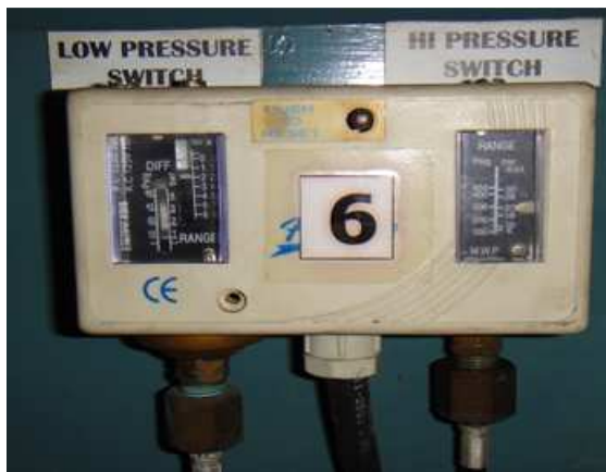
รูปที่ 2.14 สวิตช์ควบคุมความดัน(Pressure Switch)
