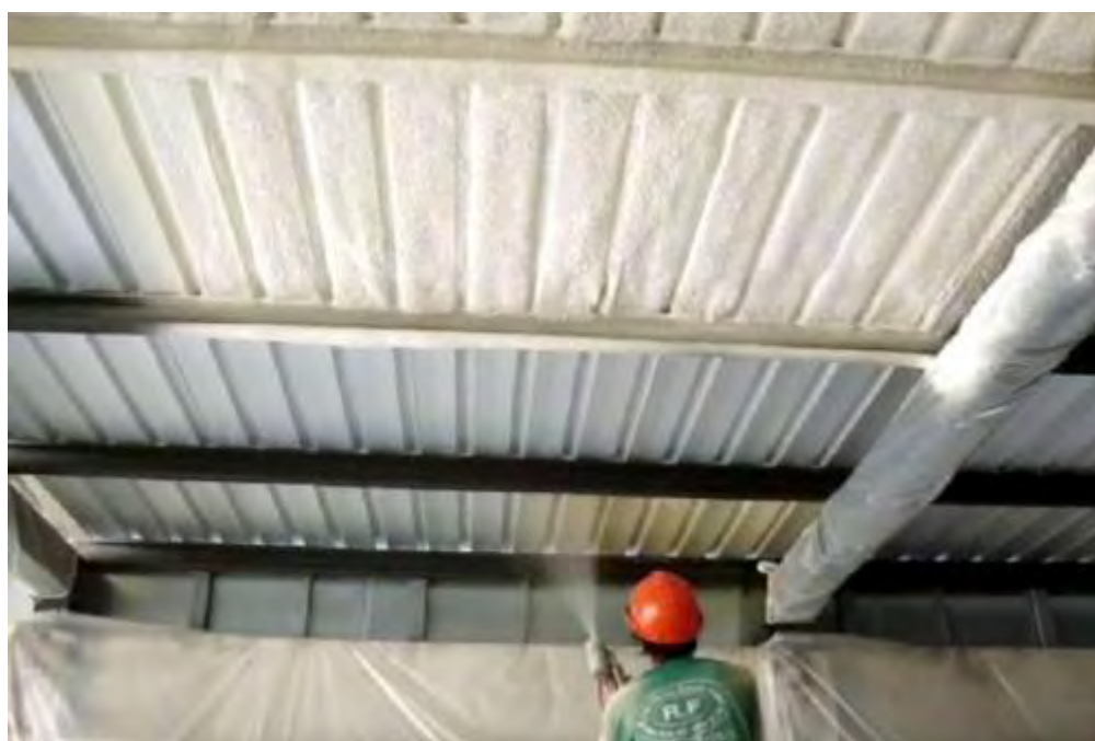
รูปที่ 3.17 ฉนวนกันความร้อนใต้หลังคา
