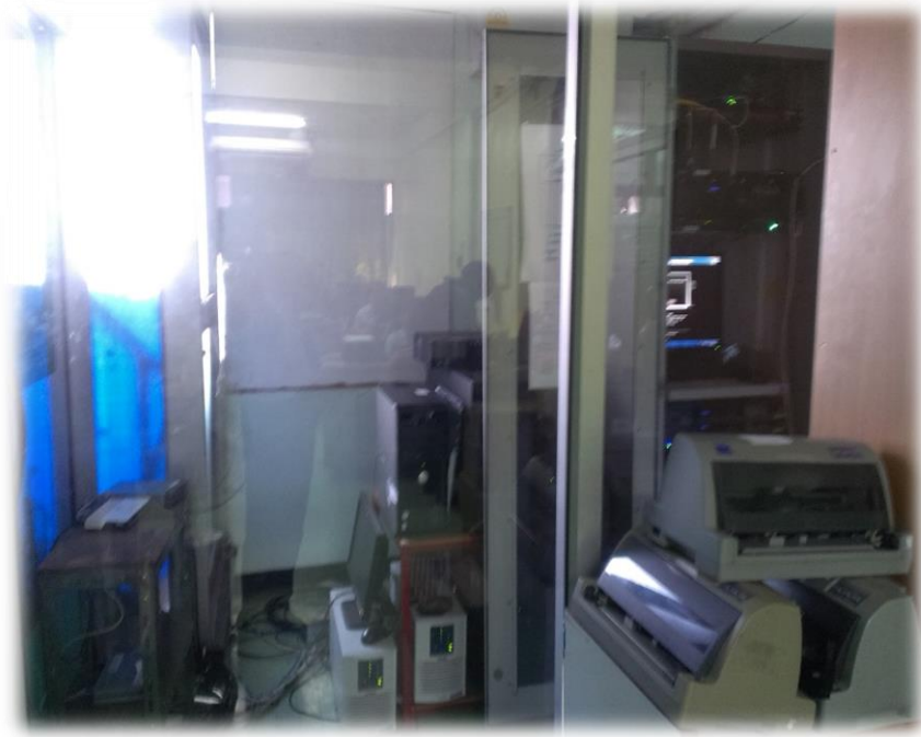
รูปที่ ก.6 ห้อง SERVER ของแผนก IT
