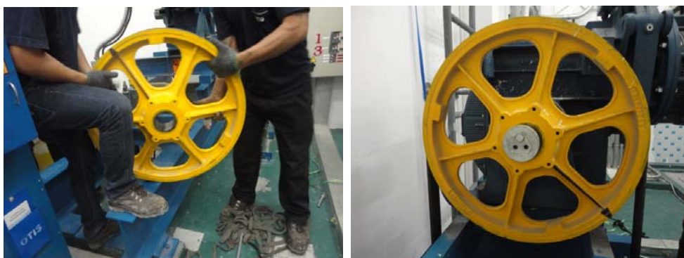
รูปที่ 4.3 การเปลี่ยนชีพที่มอเตอร์ของลิฟท์สำหรับร้อยสายสลิงลิฟท์เนื่องจากร่องชีพสึก
