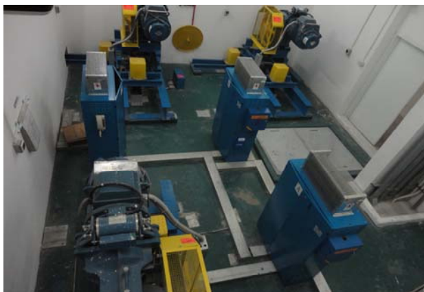
รูปที่ 4.1 ที่ตั้งอุปกรณ์ควบคุม และ มอเตอร์ภายในห้องลิฟท์
