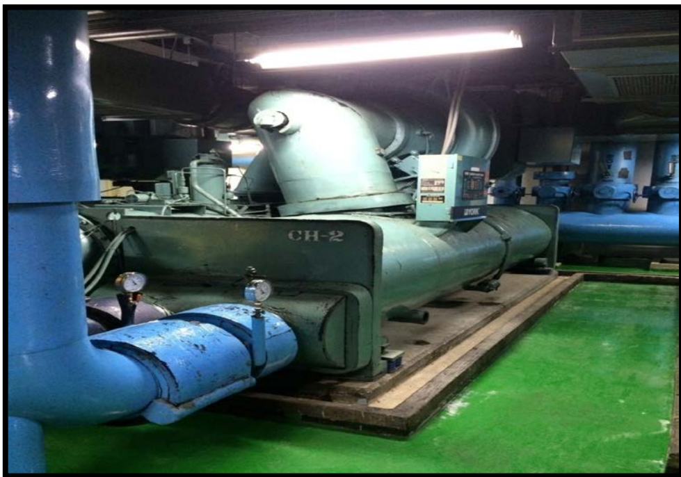
រូបទី ៣.6 chiller
