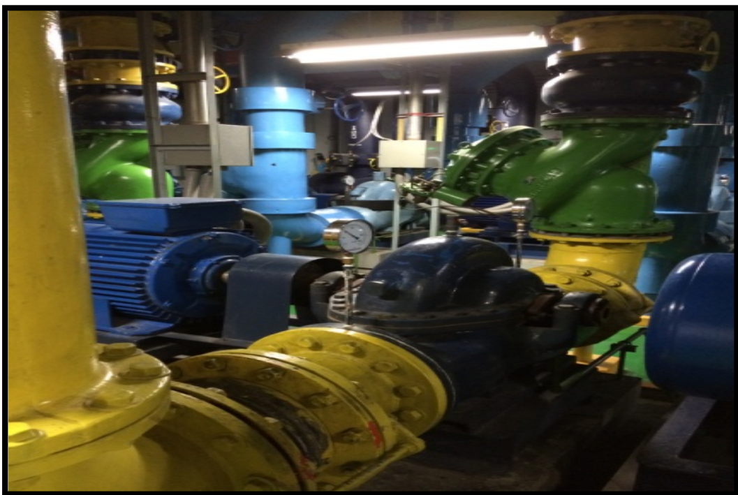
รูปที่ ก.4 chilled water pump 4
