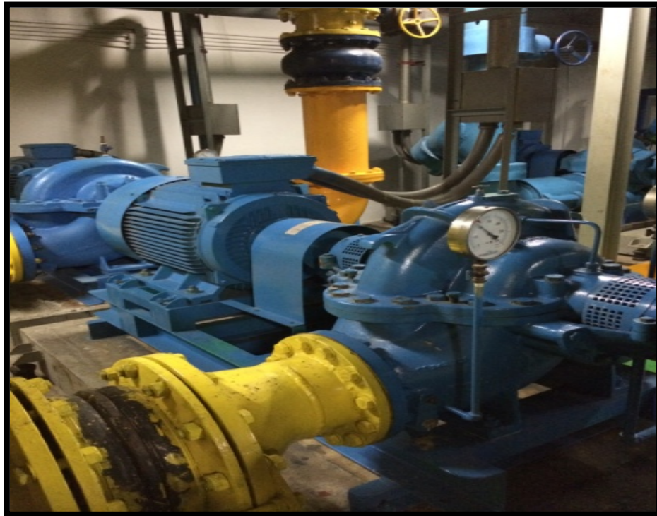
รูปที่ ก.2 chilled water pump 2
