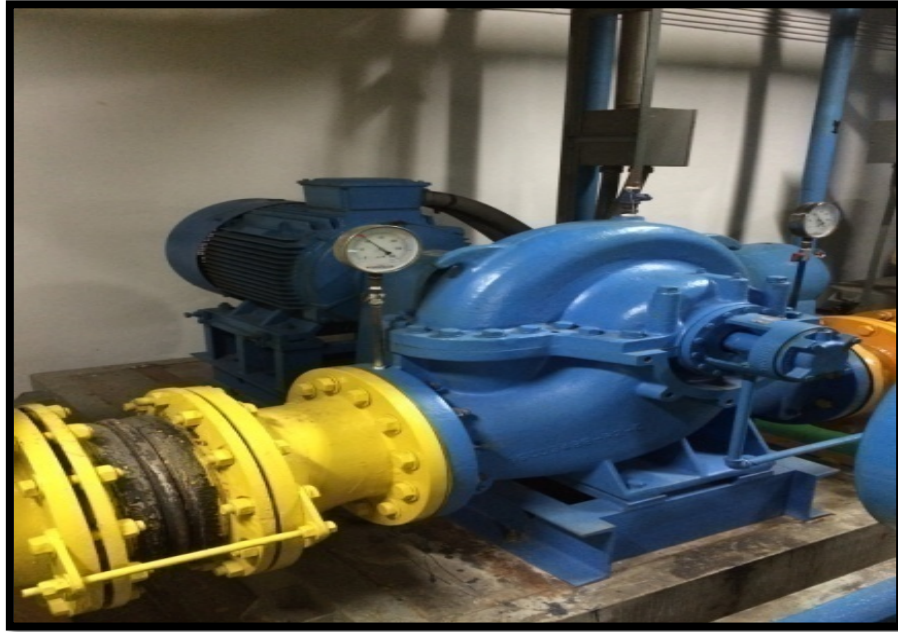
รูปที่ ก.1 chilled water pump 1
