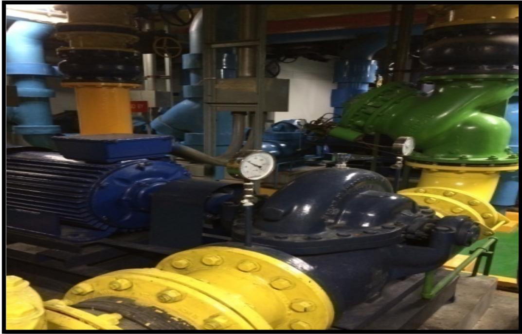
รูปที่ ก.3 chilled water pump 3
