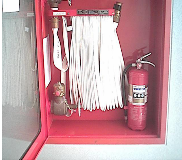
รูปที่ 2.27 ตู้ฉีดน้ำดับเพลิง (Fire Hose Cabinet)
