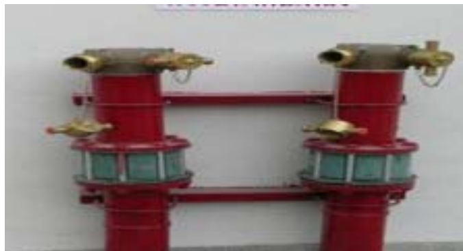
รูปที่ 3.6 หัวจ่ายน้ำ (Fire Hydrant)
