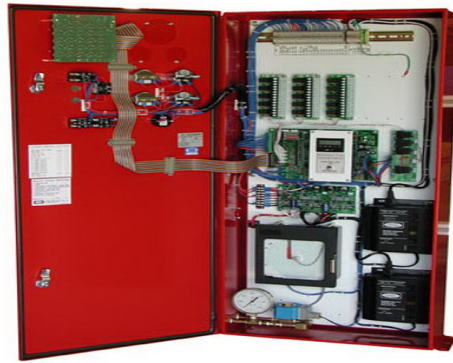
รูปที่ 3.5 ตู้ควบคุมเครื่องสูบน้ำรักษาแรงดัน (Jockey Pump Controller) และเครื่องสูบน้ำดับเพลิง (Fire Pump Controller)
