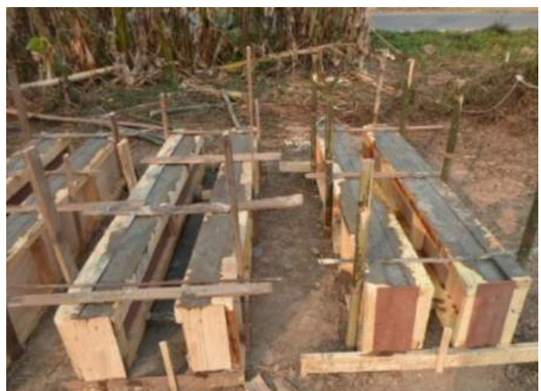
รูปที่ 15 การประกอบแบบหล่อและเทคอนกรีตผสมน้ำยางพารา
