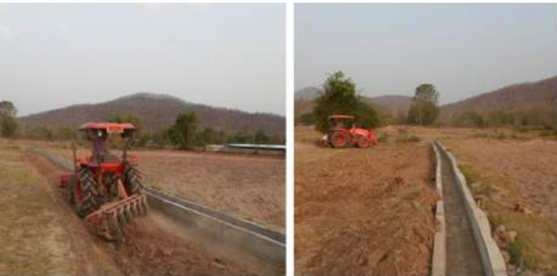
รูปที่ 23 รถแทรกเตอร์ไถเปิดหน้าดินสำหรับทำคันคูส่งน้ำ
