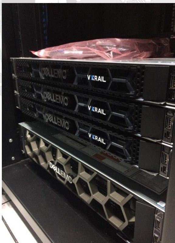
รูปที่ 3.5 ติดตั้งเครื่องเซิร์ฟเวอร์ DELL EMC รุ่น VXRAIL
