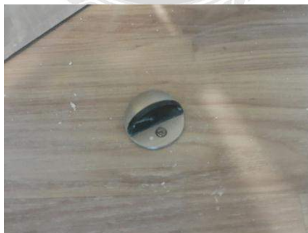
รูปที่ 4.37 ตัวหยุดประตูไม่แน่น
