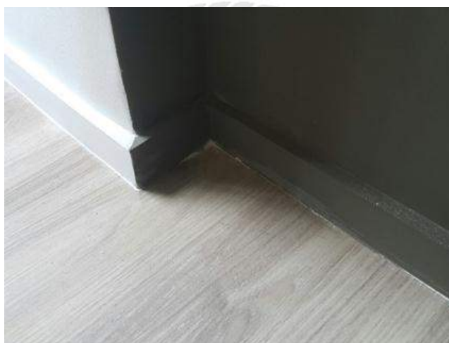
รูปที่ 4.30 เก็บงานบัวติดตั้งไม่เรียบร้อย / เอียง
