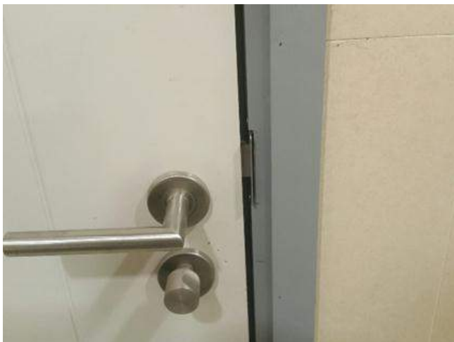
รูปที่ 4.14 ประตูห้องน้ำ ปิดแล้วไม่แน่น
