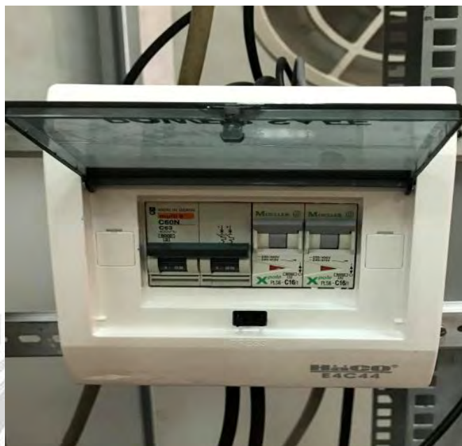
รูปที่ 4.25 Circuit Breaker
