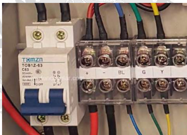
รูปที่ 2.22 อุปกรณ์ตัดตอนของระบบโซลาร์เซลล์
