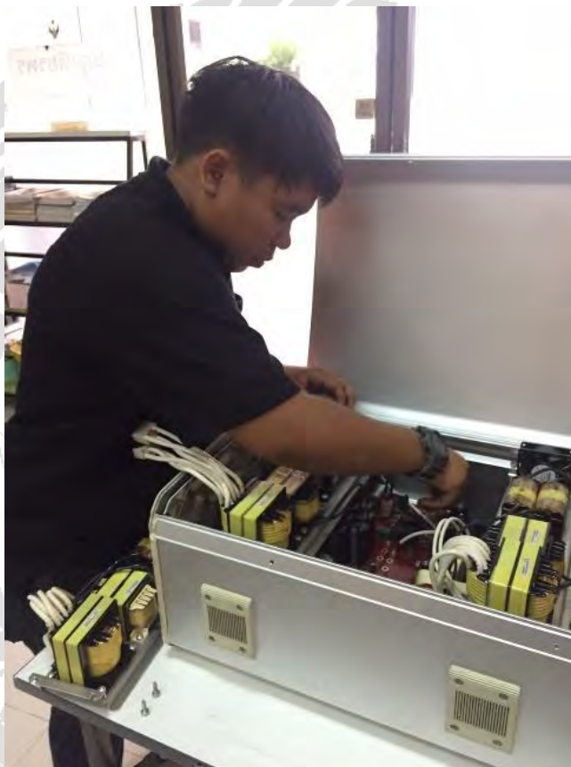
รูปที่ 4.19 ขั้นตอนการตรวจสอบเครื่องอินเวอร์เตอร์
