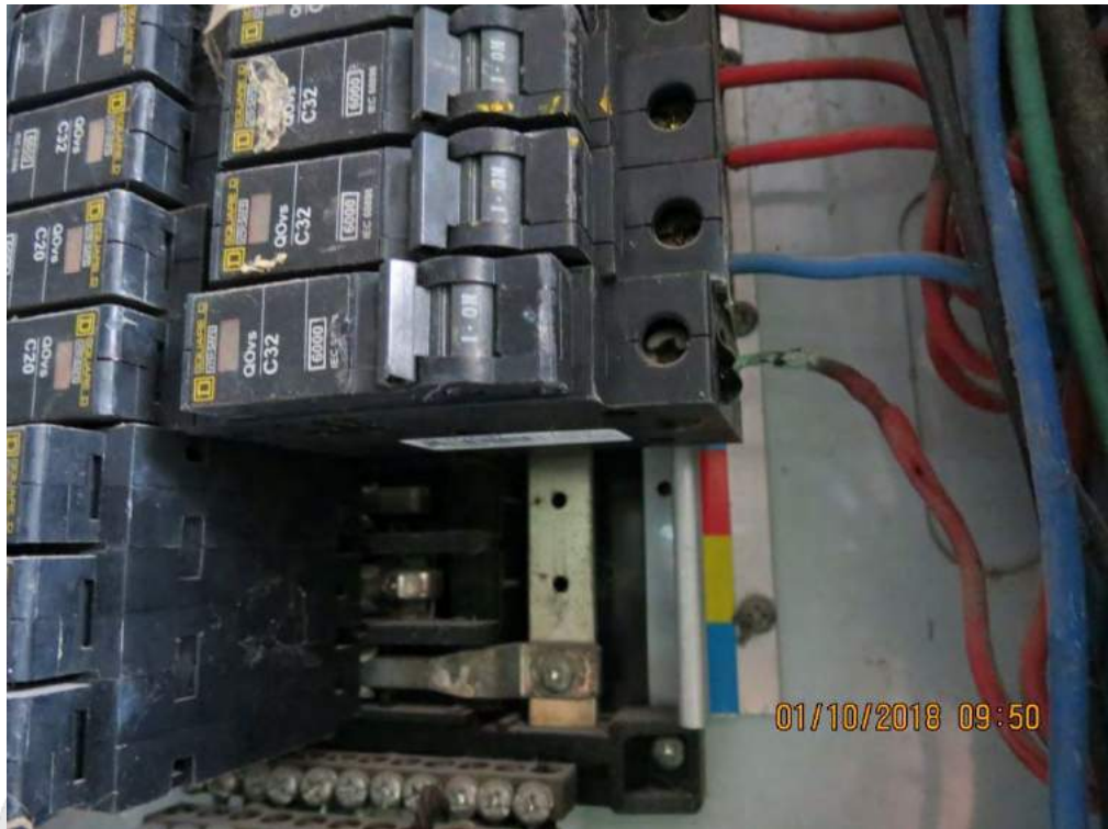
รูปที่ 17 Circuit Breaker ที่มีการไหม้
