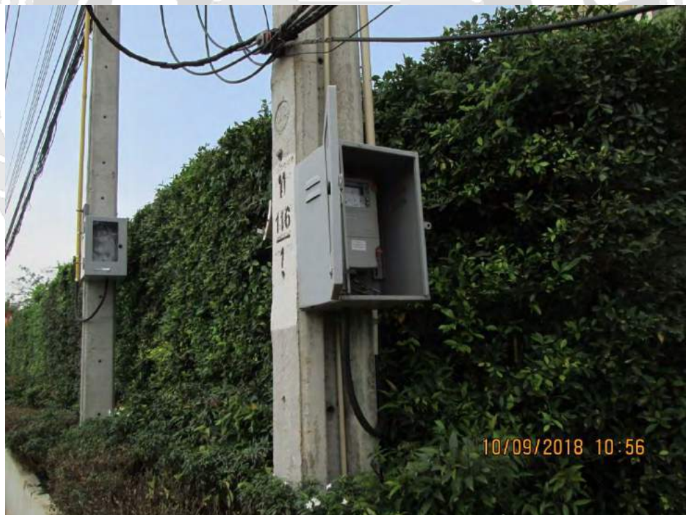
รูปที่ 20 มิเตอร์ไฟฟ้า
