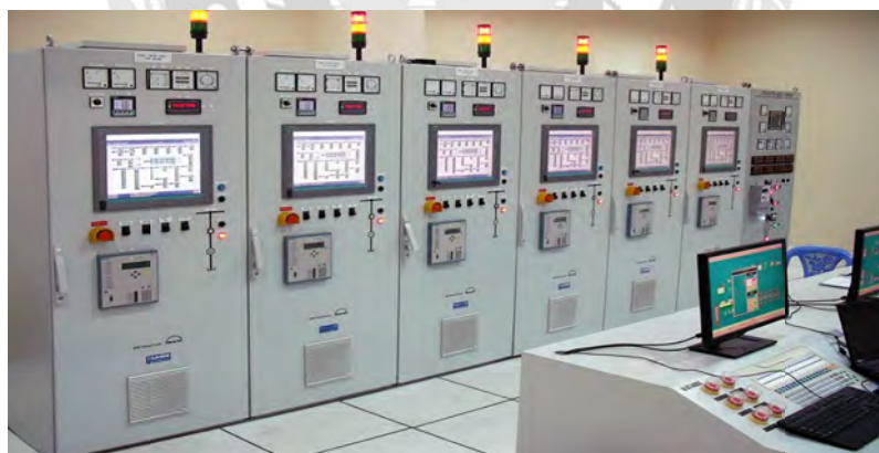
รูปที่ 2.3 ผู้ควบคุมระบบไฟฟ้า
