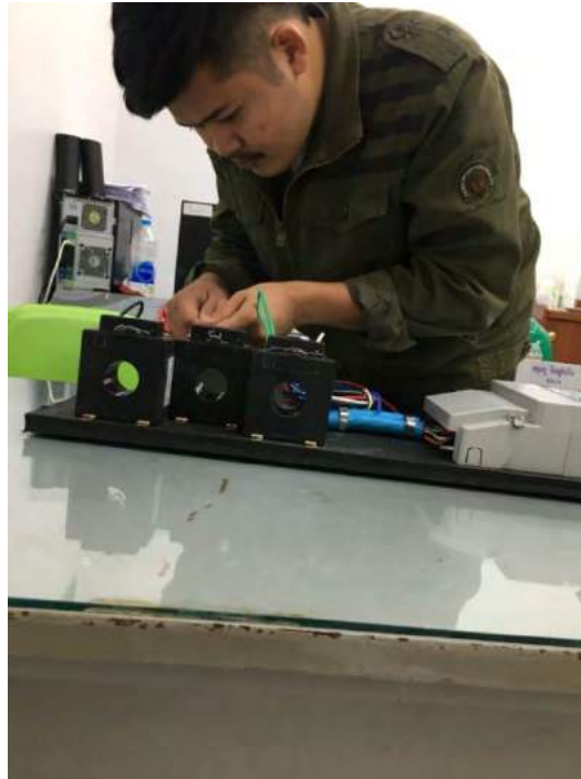
ภาพผนวก ก รูปที่ 12 ติดตั้ง CT
