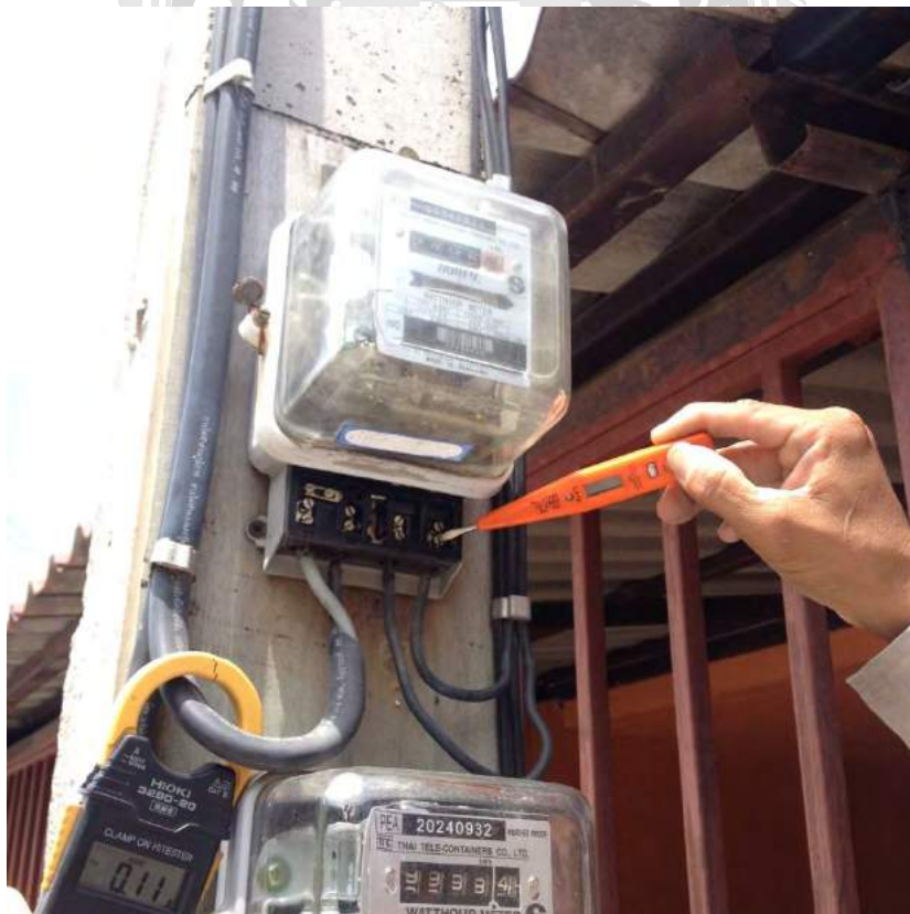
ภาพผนวก ข รูปที่ 31 ตรวจสอบการทำงานของมิเตอร์
