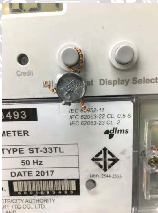
รูปที่ 4.16 ตราตะกั่วที่ติดตราการไฟฟ้า
