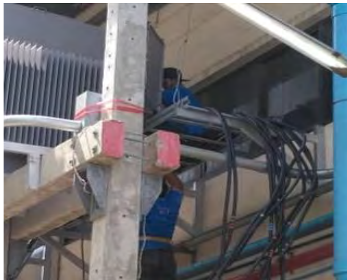
รูปที่ 4.21 สายไฟที่หม้อแปลง 24 เส้น
