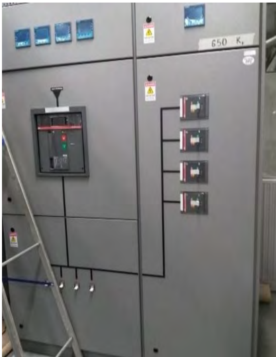
รูปที่ 4.4 ตู้ควบคุมย่อย (SDB)
