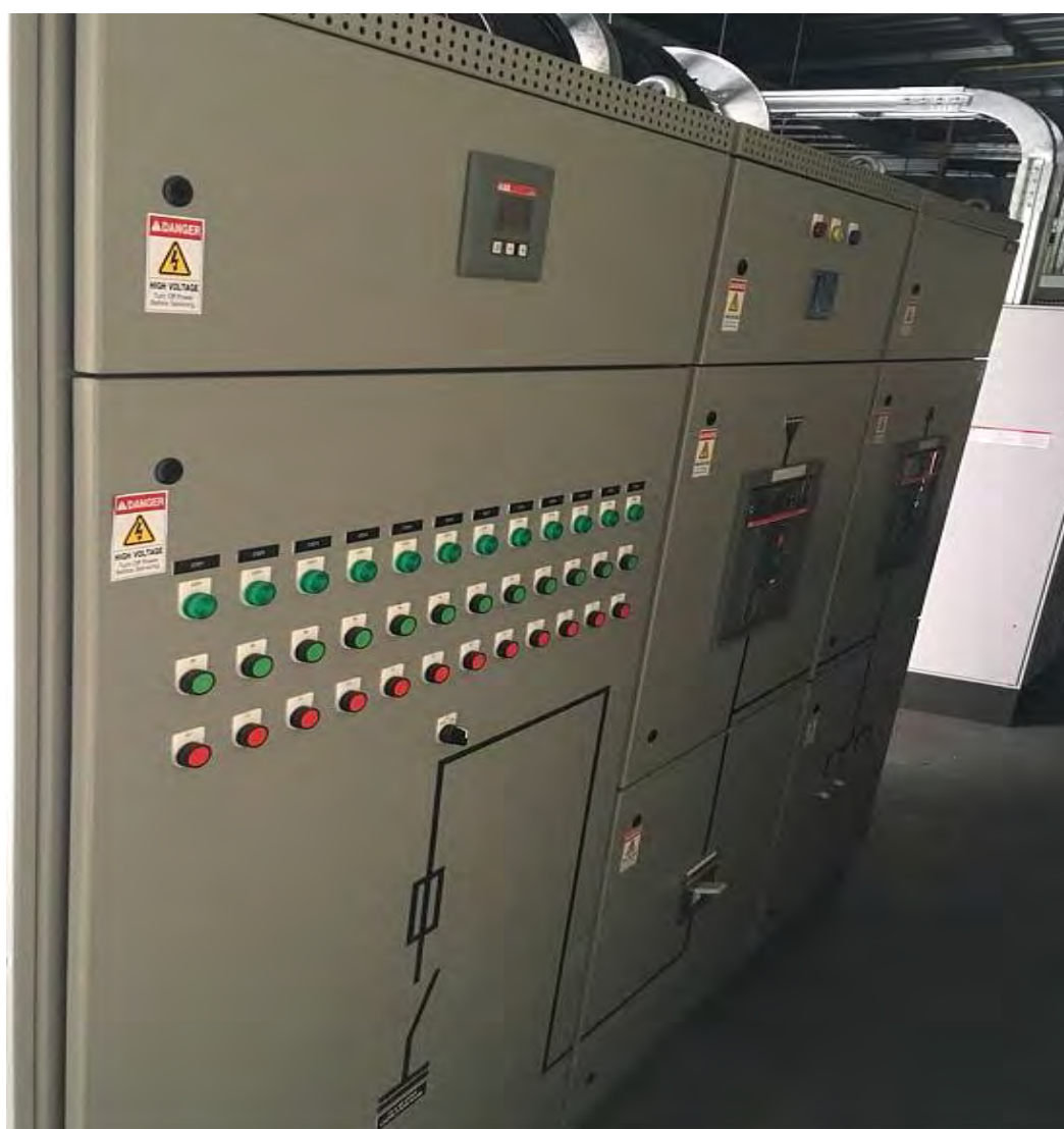
รูปที่ 4.2 ตู้ควบคุมหลัก (MDB)
