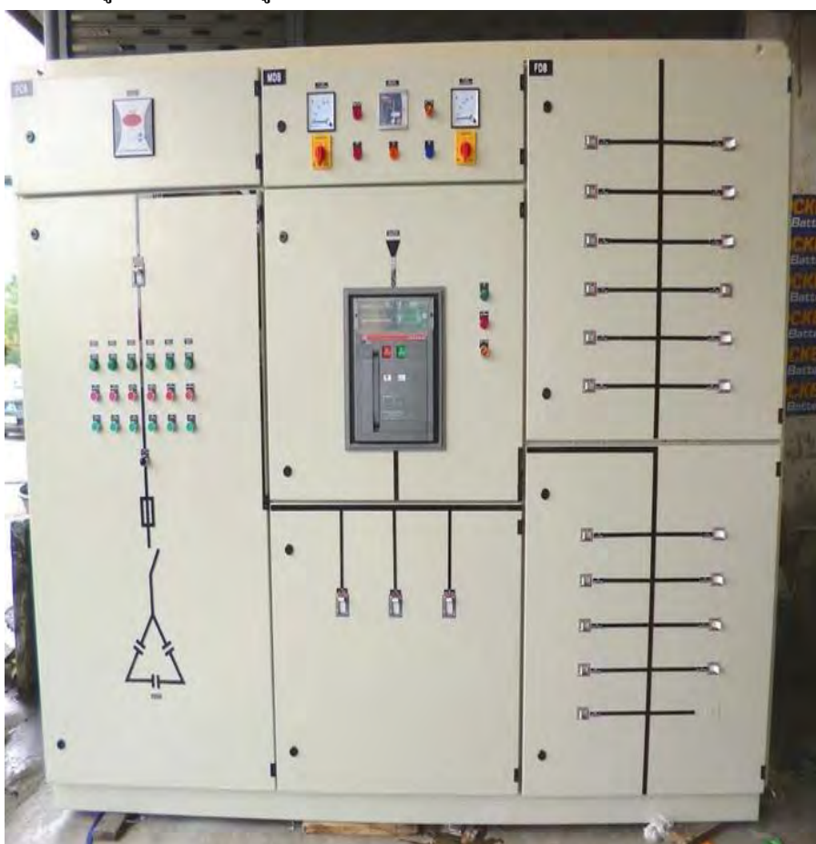
รูปที่ 2.12 ตู้ MDB ( Main Distribution Board )
