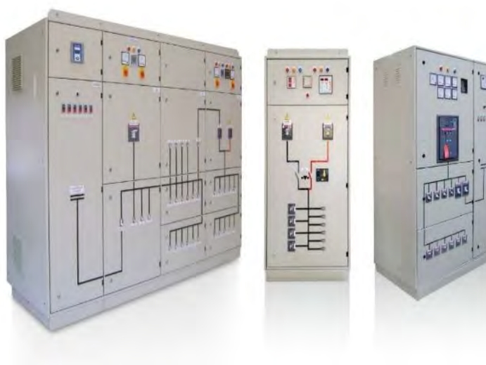
รูปที่ 2.13 ตู้ SDB ( Sub Distribution Board )
