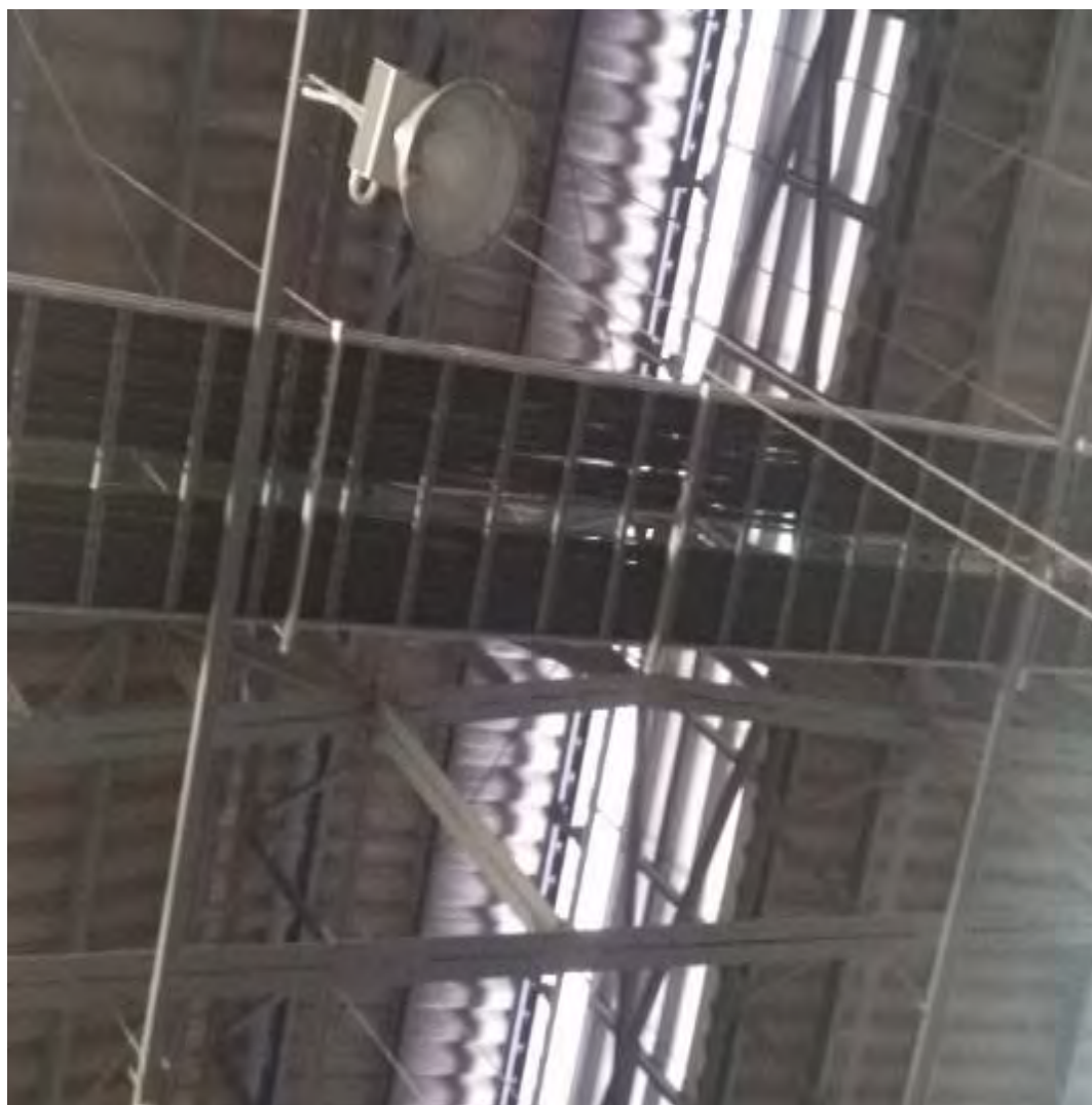
รูปที่ 4.8 การเดินสายบนแลคเตอร์ในอาคาร
