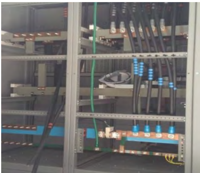
รูปที่ 4.23 สายไฟจากหม้อแปลงมาที่ MDB ที่ครบ
