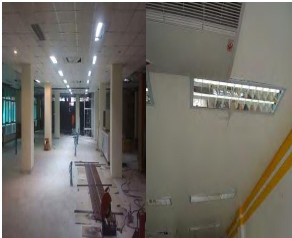
รูปที่ 4.3.9 ระบบ แสงสว่างภายในอาคาร
