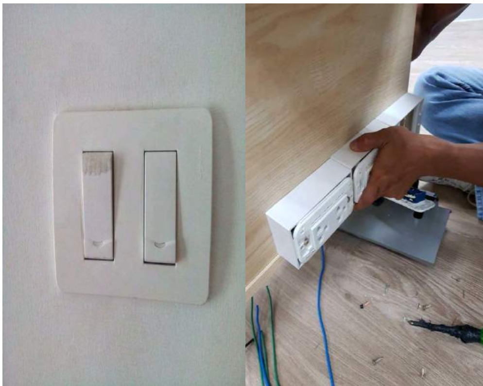
รูปที่ 4.3.7 สวิตช์ไฟ และ ปลั๊กไฟ
