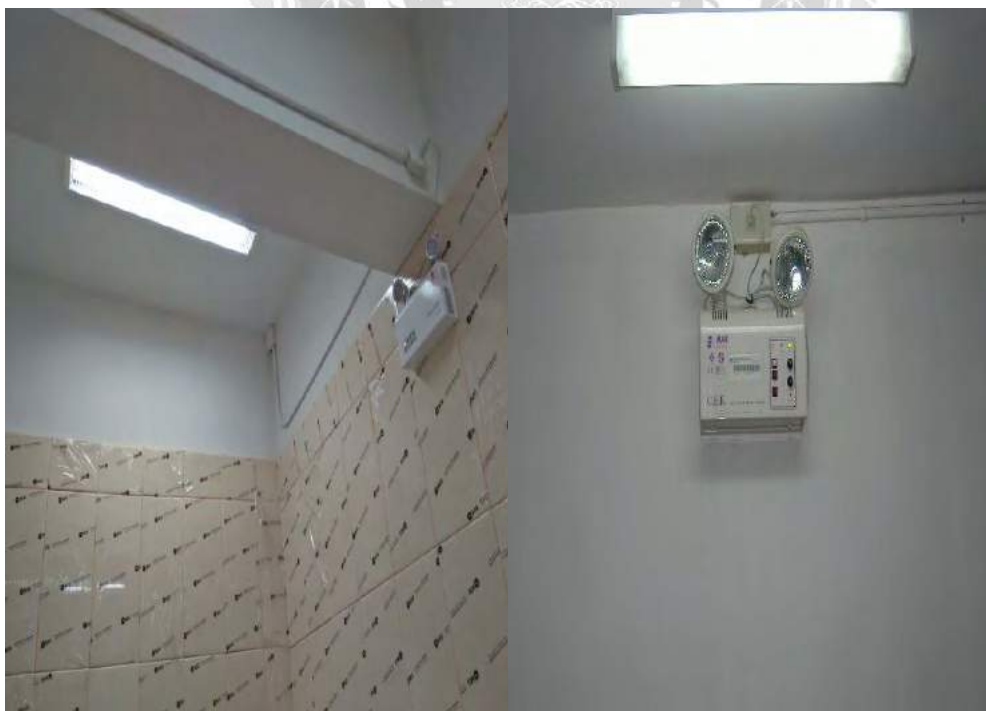
รูปที่ 4.3.8 ไฟฉุกเฉิน หรือแสงสว่างสำรองในอาคาร
