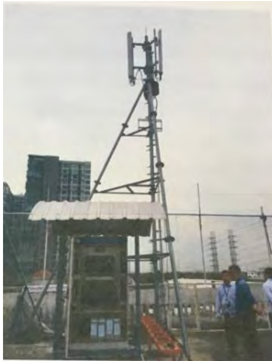
รูปที่ 2.33 สถานีฐานแบบ On Roof
