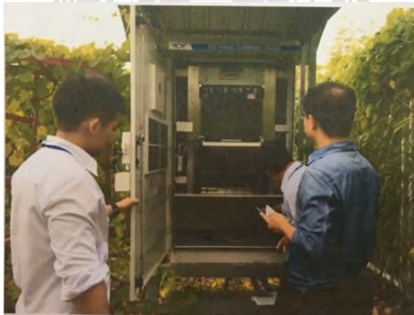
รูปที่ 2.34 Core Switching and Power-Supply
