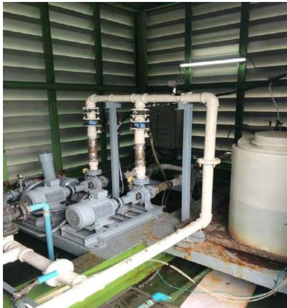
รูปที่ 4.23 Pump ระบบ น้ำบำบัด WT
