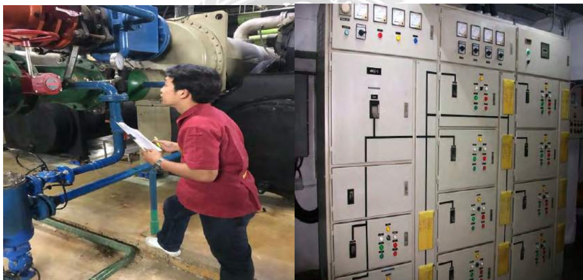
รูปที่ 4.18 ปั๊มน้ำหล่อเย็น COP และ ตู้ควบคุม COP
