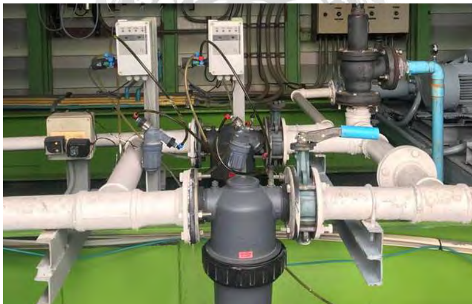
รูปที่ 4.24 ระบบกรองน้ำบำบัด
