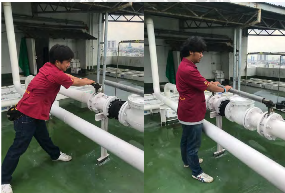
รูปที่ 4.42 เปิด-ปิด วาล์วน้ำเข้า ระบบบำบัด
