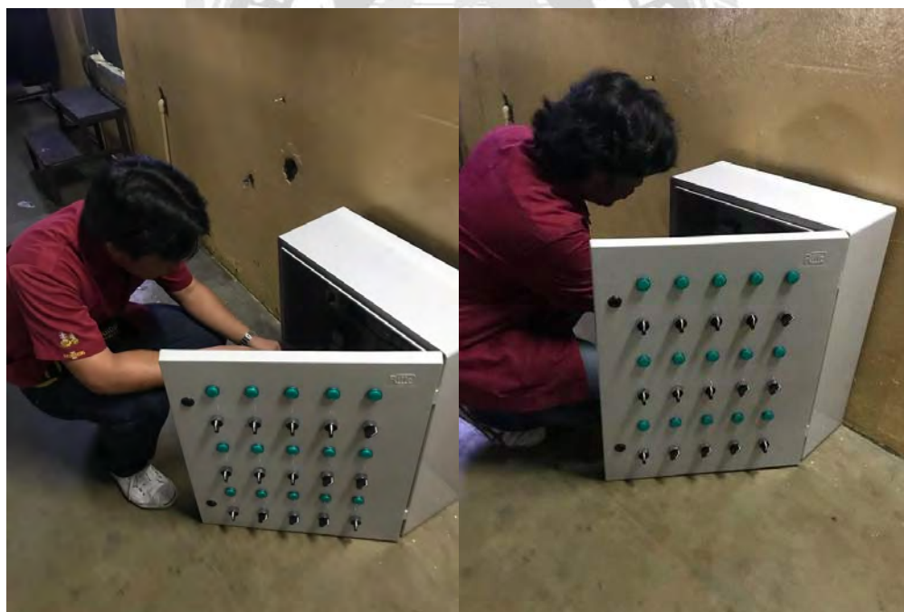
รูปที่ 4.44 ตรวจสอบเช็คอุปกรณ์ต่าง ๆ ภายในตู้ Control
