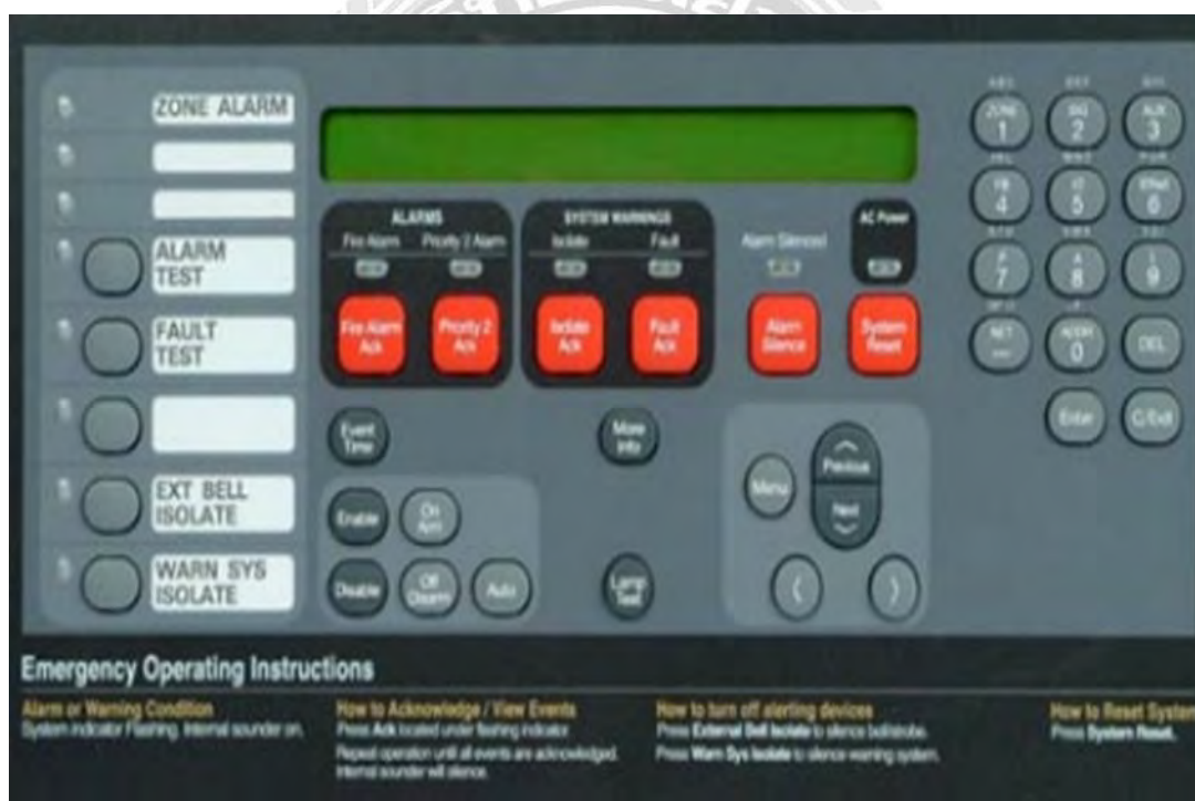
รูปที่ 2.5 แผงควบคุม ( Fire Alarm Control Panel )
