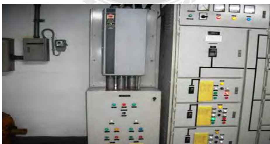
รูปที่ 4.17 VSD ควบคุมปั๊ม COP
