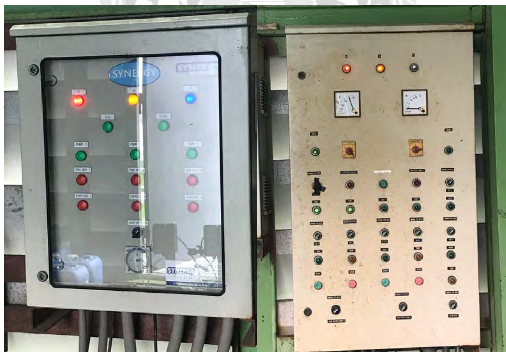
รูปที่ 4.22 ตู้ควบคุม ระบบ WT
