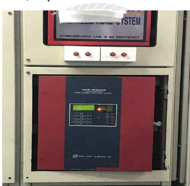
รูปที่ 4.4 ตู้ Fire Alarm System
