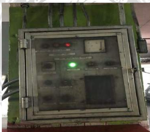
รูปที่ 4.35 ตู้ควบคุมระบบแก๊ส และ ตู้ควบคุมหม้อต้มแก๊ส
