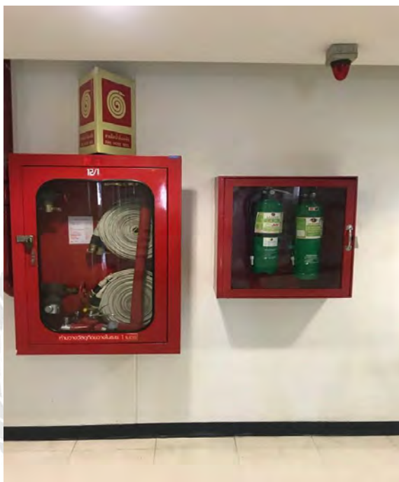
รูปที่ 4.12 ตู้ และ สายดับเพลิง
