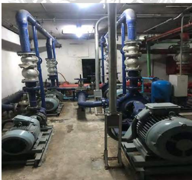
รูปที่ 4.20 ระบบปั้มน้ำดี WP
