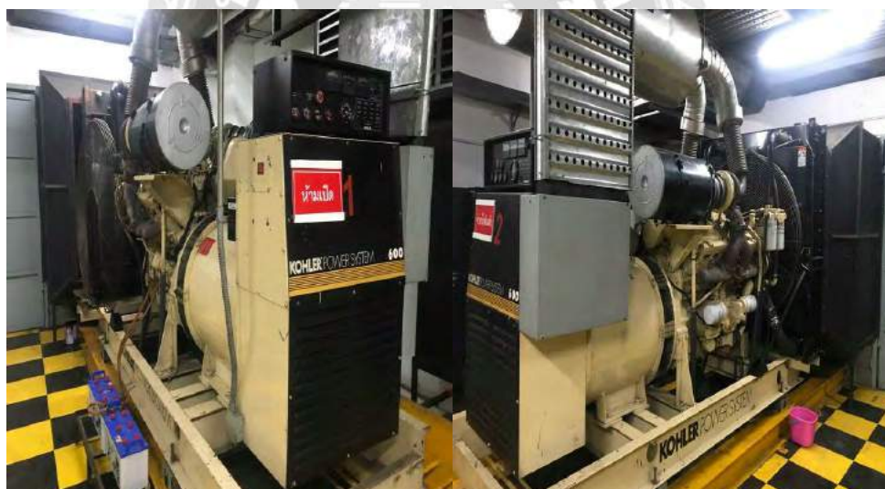
รูปที่ 4.29 เครื่องสำรอง Generator และ พัดลมระบายความร้อน
