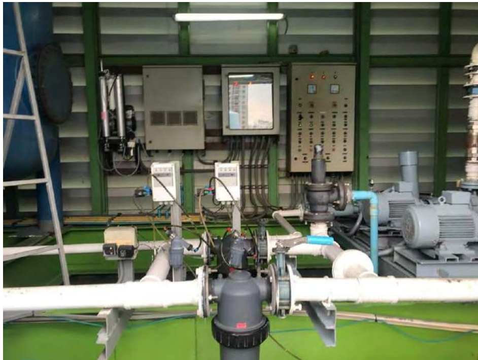
รูปที่ 4.21 ห้องควบคุมระบบน้ำบำบัด
