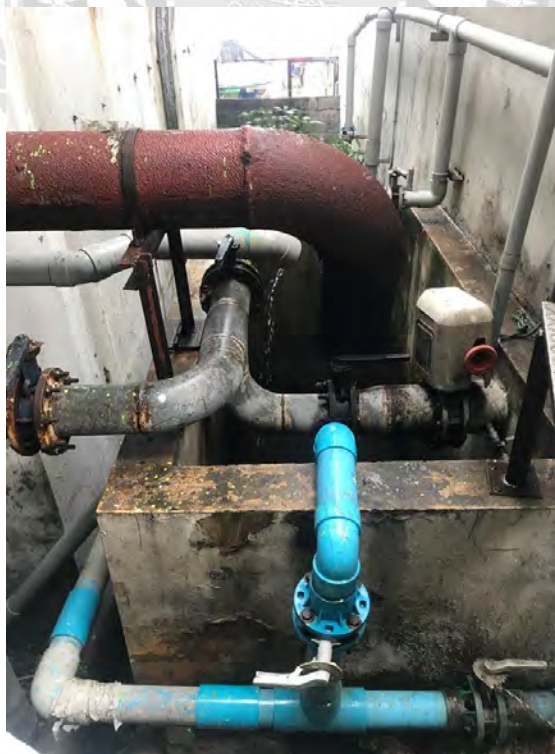
รูปที่ 4.28 บ่อดักน้ำเสีย, บ่อน้ำทิ้ง
