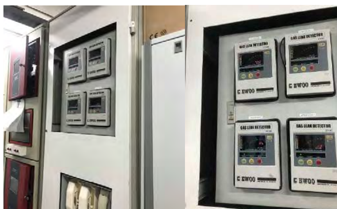
รูปที่ 4.36 ตู้ควบคุมเตือนแก๊สหมด และ ตู้ควบคุมตรวจจับแก๊สรั่ว
