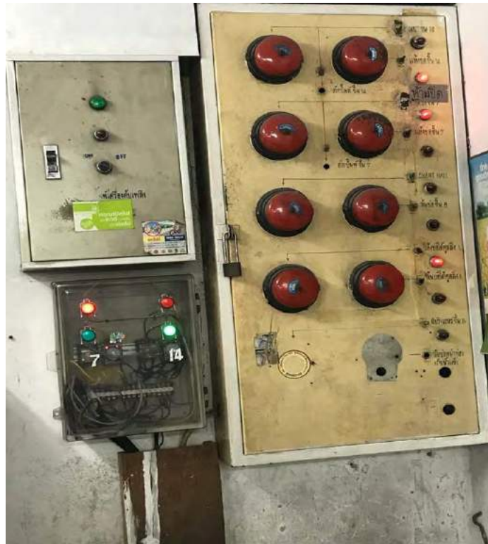
รูปที่ 4.27 ตู้ควบคุม ระบบ SLR และ Bell แจ้งเตือน เมื่อน้ำเต็มบ่อ
