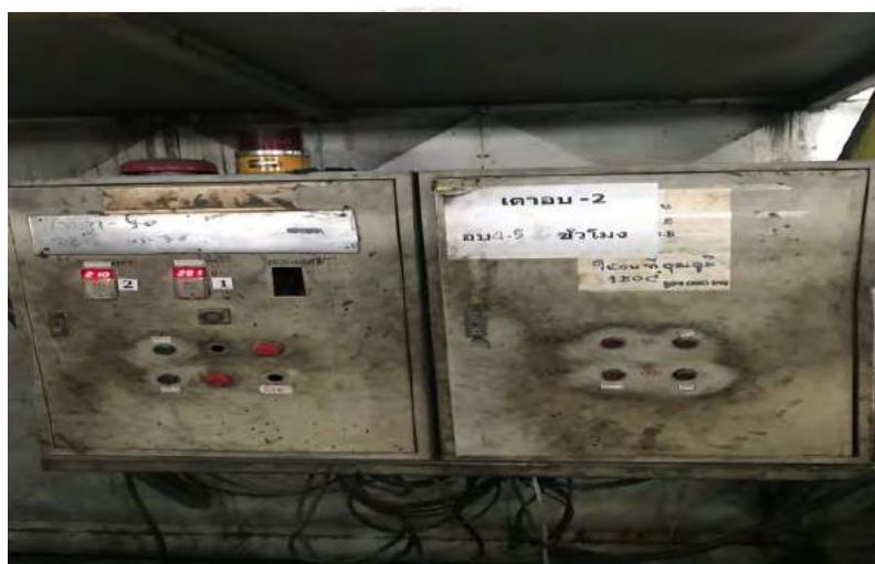
รูปที่ 4.6 ตู้ควบคุมการทำงานของเตาอบ
