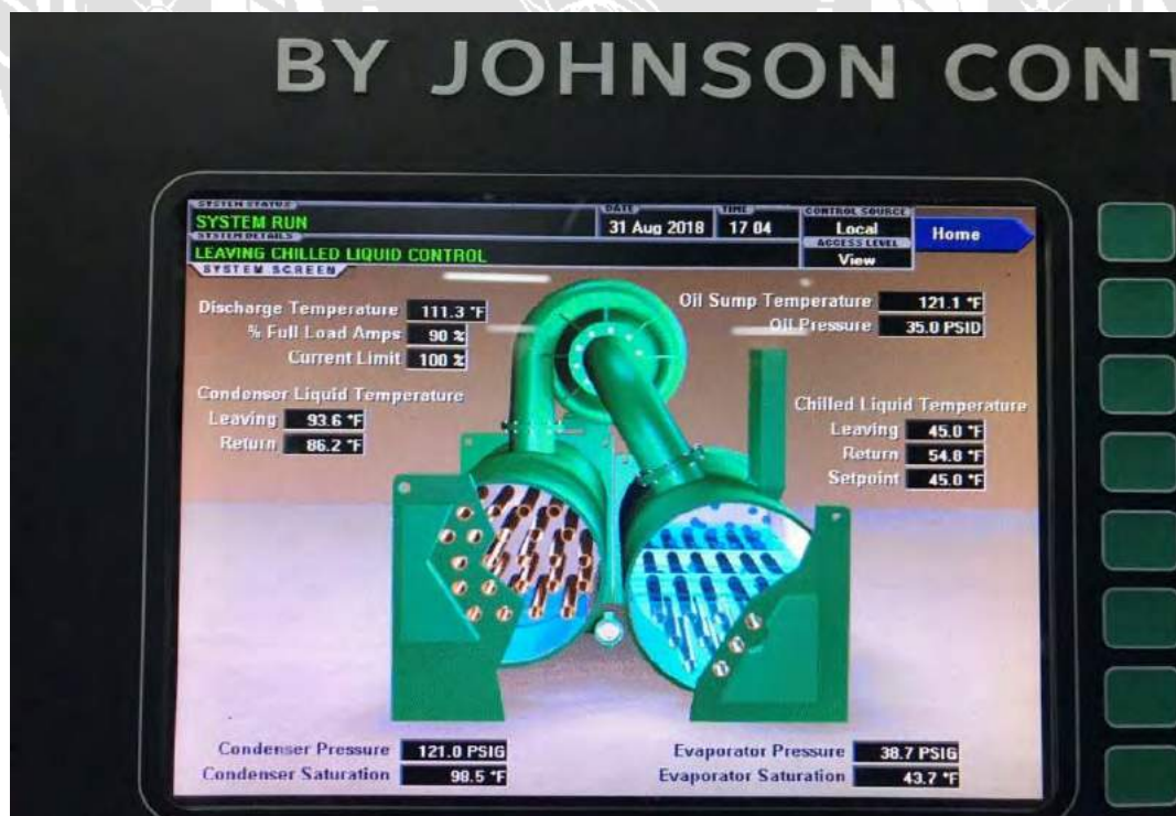
รูปที่ 4.5.2 หน้าจอ System Screen ของเครื่อง Chiller
