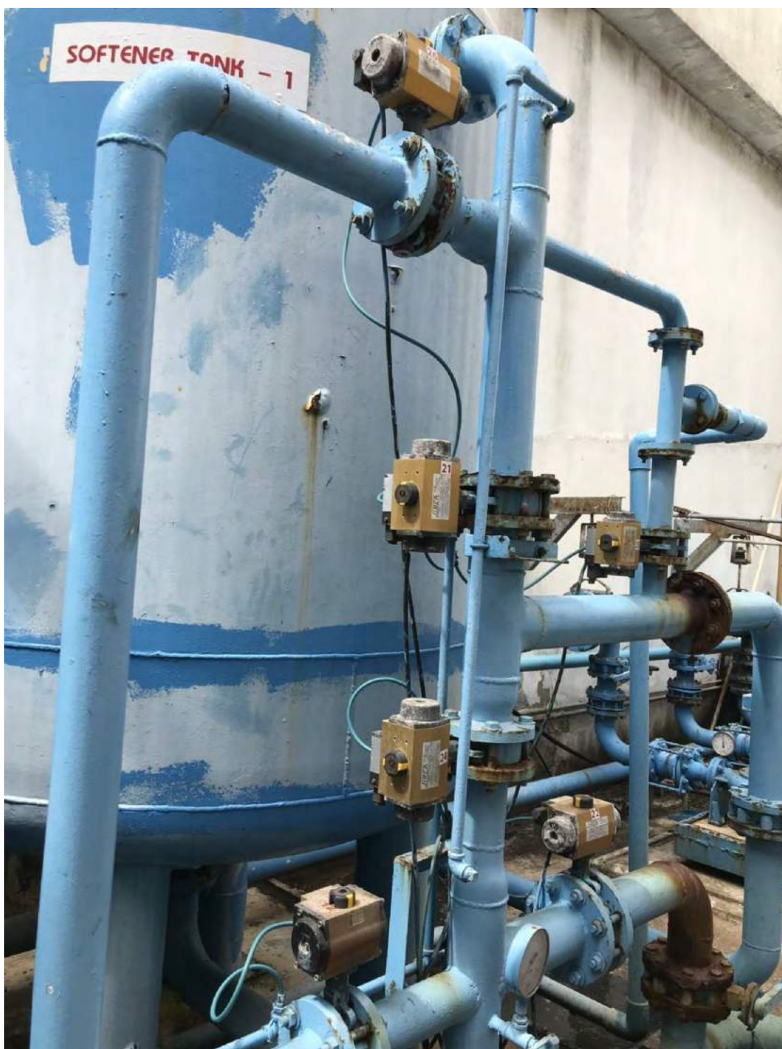
รูปที่ 2.9 เครื่องกรองความกระด้าง (Softener Filter)
