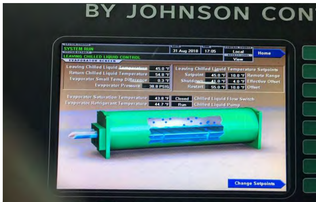
รูปที่ 4.5.3 หน้าจอ Evaporator Screen ของเครื่อง Chiller
