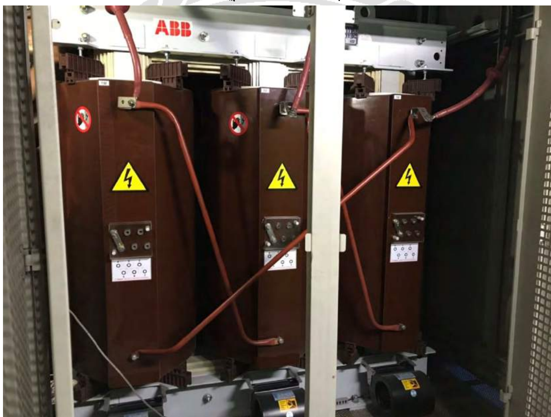
รูปที่ 4.12 หม้อแปลงที่มีการใช้งานในห้อง Substation
