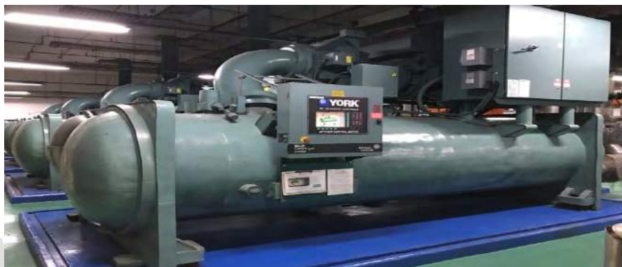
รูปที่ 4.2 เครื่อง Chiller ขนาด 1000 TON
