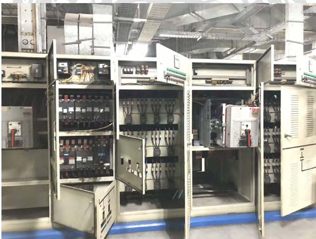
รูปที่ 4.14 ภาพของตู้เมนเบรกเกอร์หลังที่ทำการจ่ายไฟฟ้าไปยังห้องย่อย
