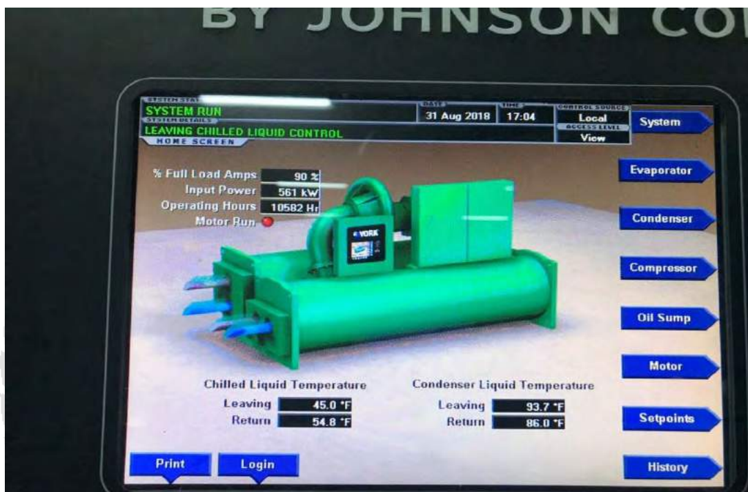
รูปที่ 4.4 หน้าจอ Display ของเครื่อง Chiller
