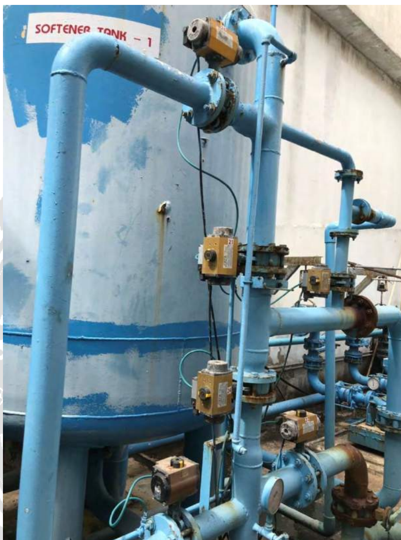
รูปที่ 4.7 ถัง Softener Filter
