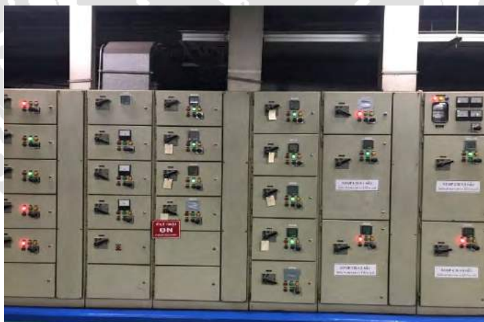
รูปที่ 4.3 ตู้ Control CT,COP,CHP,CH
