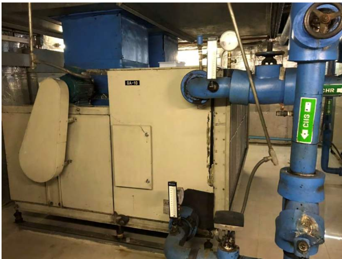
รูปที่ 2.10 AHU (Air Handling Unit)
