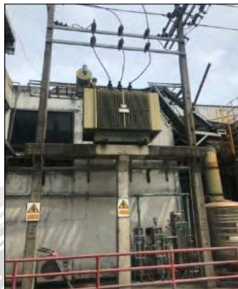
รูปที่ 4.23 หม้อแปลงภายในของผู้ใช้ไฟฟ้า
