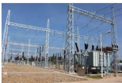
รูปที่ 2.7 สถานีย่อยไฟฟ้า
