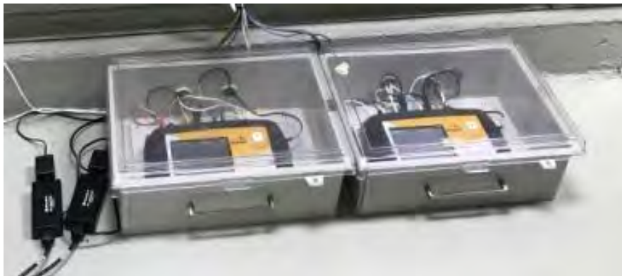
รูปที่ 4.29 ลักษณะการติดตั้ง PQ Meter
