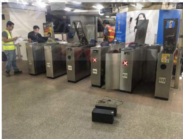
รูปที่ 4.22 ตัดระบบจ่ายไฟเพื่อความปลอดภัย
