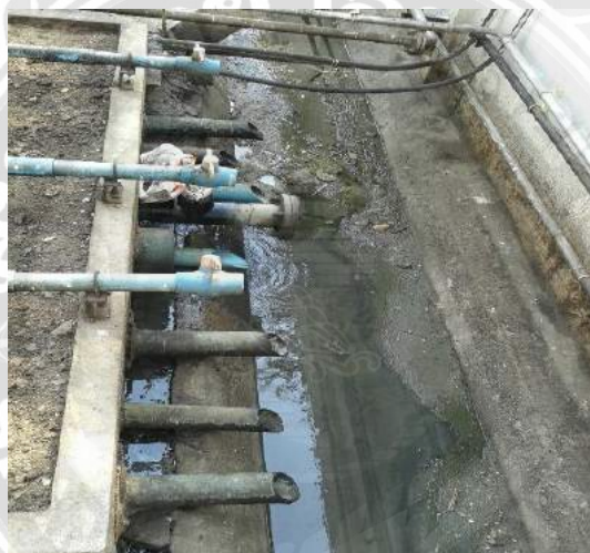
รูปที่ 1.7 สภาพบ่อดักไขมันในปัจจุบัน
