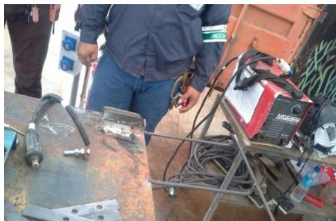
รูปที่ 4.6 อุปกรณ์ไฟฟ้าที่เป็นอันตราย ไม่ได้มาตรฐาน
