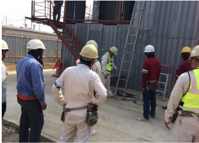
รูปที่ 4.4 การตรวจหาอันตรายในบ้านพักคนงาน
