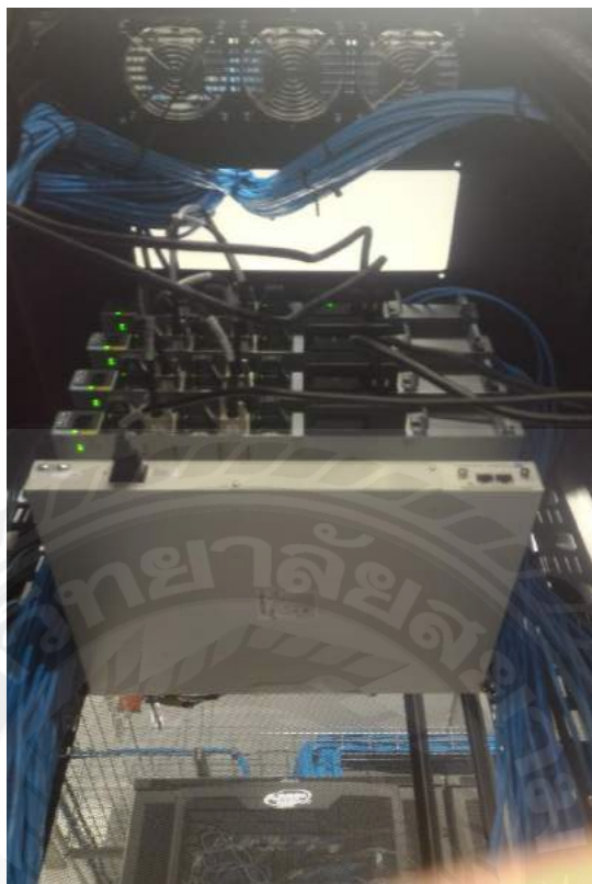
รูปที่ ก.1 การจัดสาย Lan ห้อง data center ณ กรมสรรพสามิต
