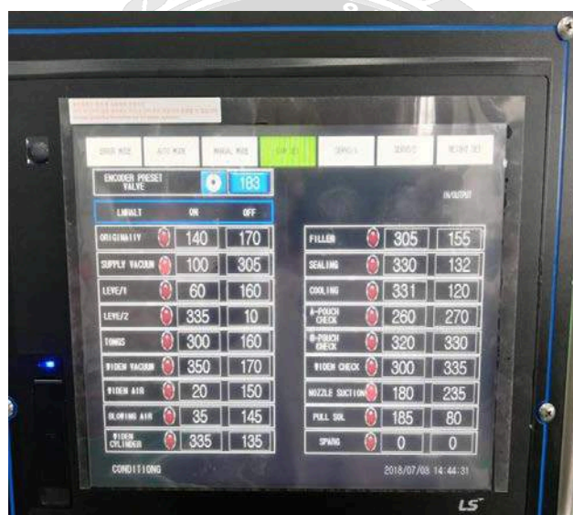
รูปที่ 3.8 จอควบคุมการทำงานระบบ PLC
