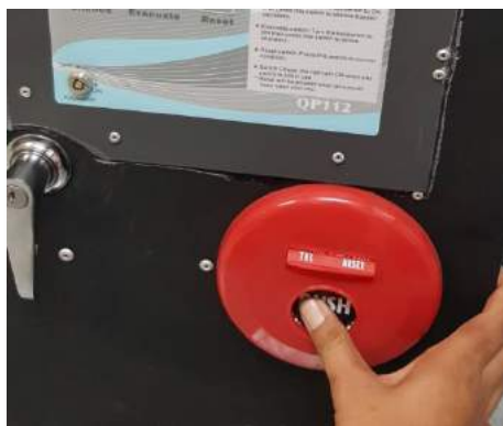
รูปภาพที่ 4.15 ตู้ควบคุมระบบแจ้งเหตุเพลิงไหม้
