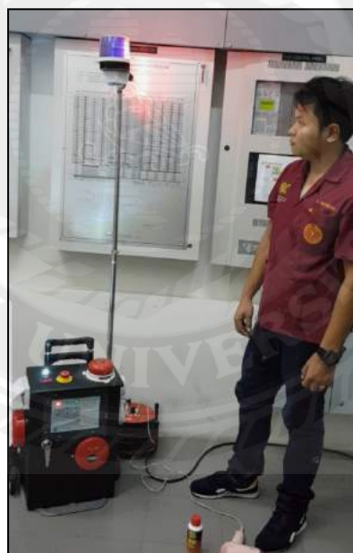
รูปภาพที่ 4.17 การทดสอบเมื่ออุปกรณ์ตรวจจับรับสัญญาณ และส่งสัญญาณแจ้งเตือนเหตุเพลิงไหม้
