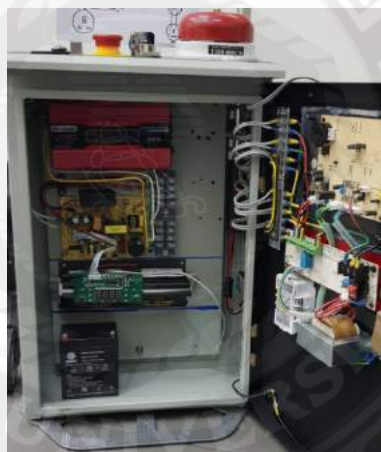
รูปที่ 3.17 จัดวางตำแหน่งชุดแหล่งจ่ายพลังงานไฟฟ้าภายในตู้ควบคุม
