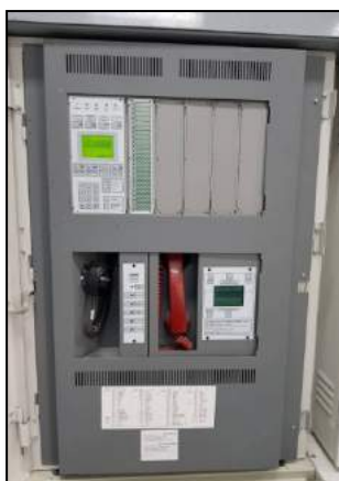
รูปที่ 2.5 ตู้ควบคุม (Fire Alarm Control Panel)
