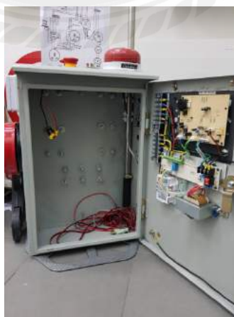
รูปที่ 3.15 ติดตั้งสายไฟฟ้าของวงจรและหน้าจอแสดงการทำงาน ของระบบ Fire Alarm บริเวณฝ้าตู้
