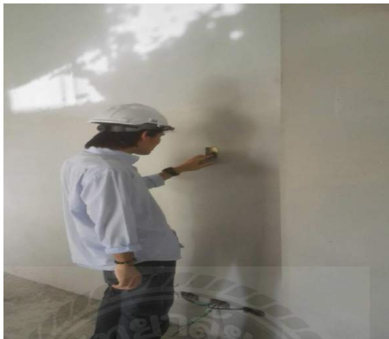
รูปที่ 6.3 การตรวจสอบจุด เอาท์เลท ระบบก๊าซทางการแพทย์
