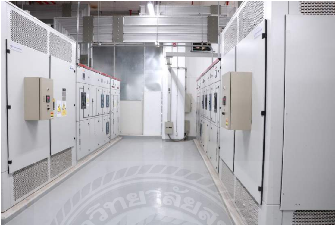
รูปที่ ค Room ( Main Distribution Board : MDB ) ( ต่อ )
