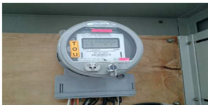
รูปที่ 3.4 มิเตอร์ไฟฟ้า
