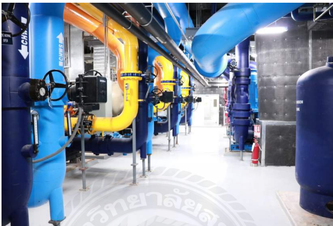
รูปที่ ง Room Chiller ( ต่อ )
