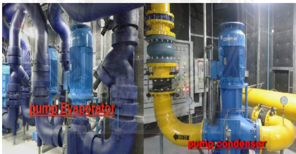
รูปที่ 2.24 Booster pump
