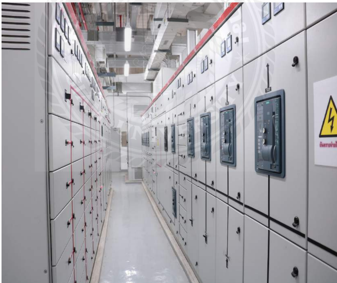
รูปที่ ค Room ( Main Distribution Board : MDB )
