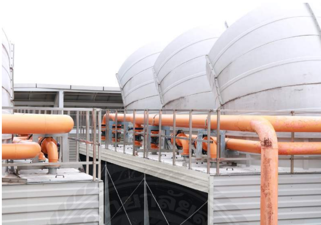
รูปที่ จ เครื่อง ระบายความร้อน Cooling Tower ( ต่อ )
