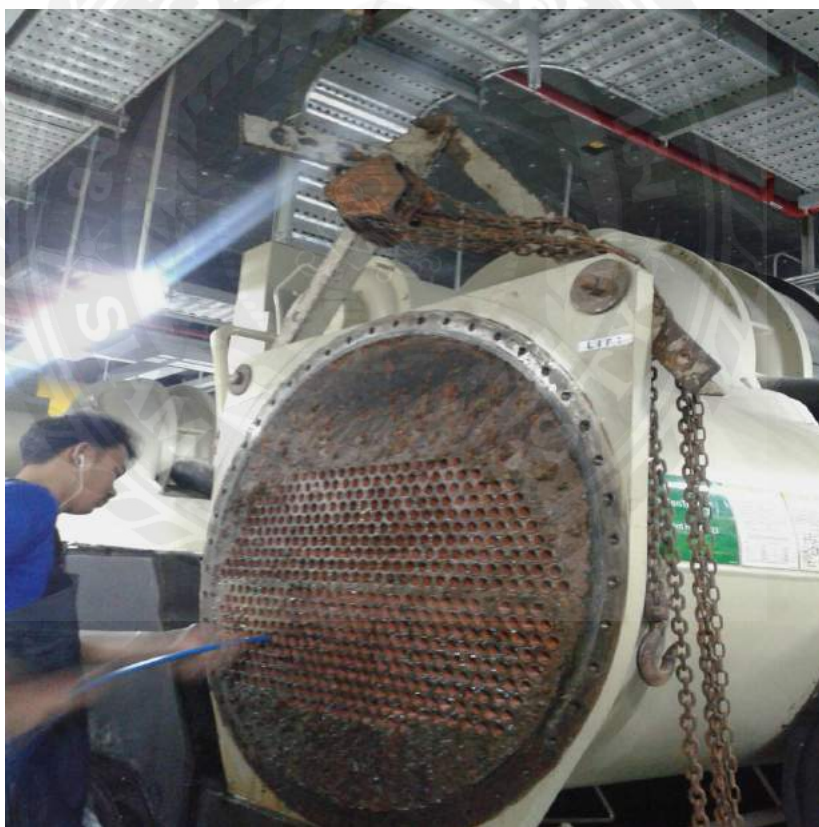
รูปที่ 4.8 ขั้นตอนการปรับปรุงสมรรถนะเครื่องทำความเย็น ( ก่อนปรับปรุง )
