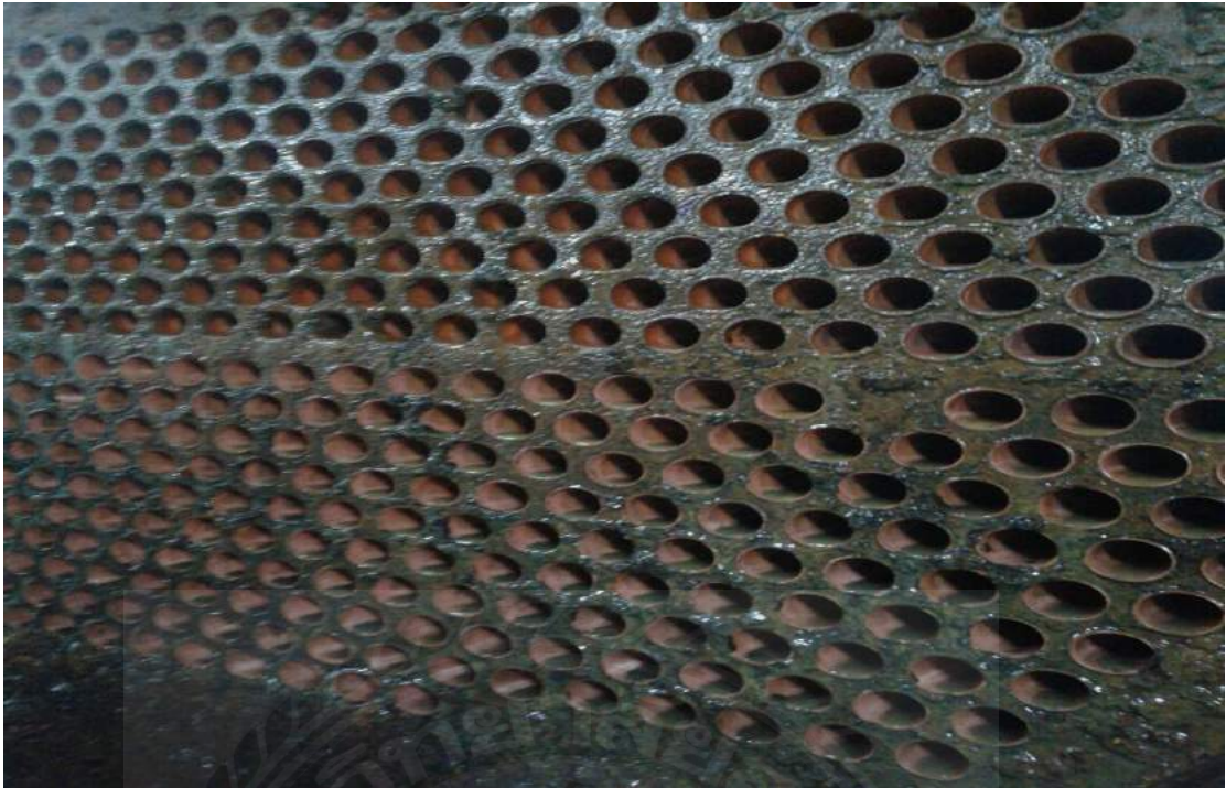
รูปที่ จ Team ช่าง ทำการล้างท่อที่เครื่อง Chiller ( ต่อ )
