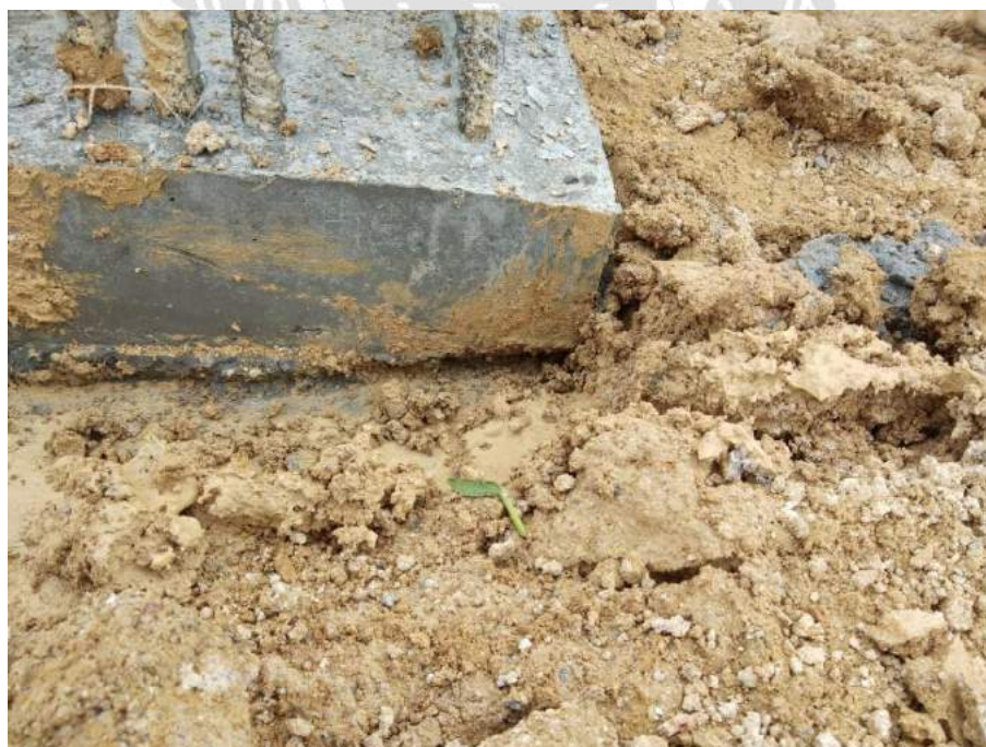
รูปที่ 4.41 ตัวอย่างตอม่อที่เทคอนกรีตโดยไม่ทำความสะอาดก่อนเท
