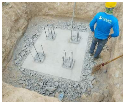
รูปที่ 4.23 กรณีที่เหล็ก Dowel Bars ไม่ครบ
