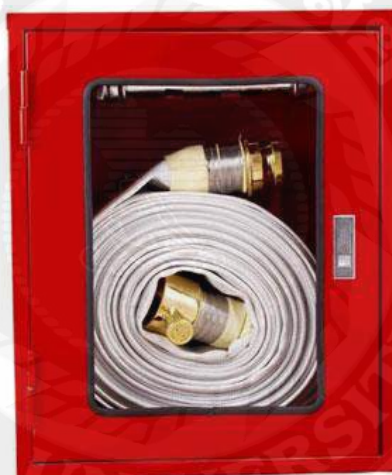
รูปที่ 2.16 สายฉีดน้ำแบบสายพับ (Fire Hose Rack Cabinet)
