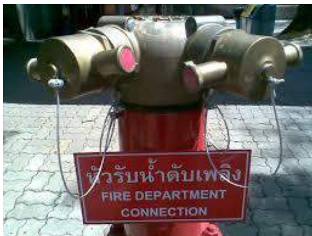
รูปที่ 2.17 ห้วรับน้ำดับเพลิง (Fire Department Connection)
