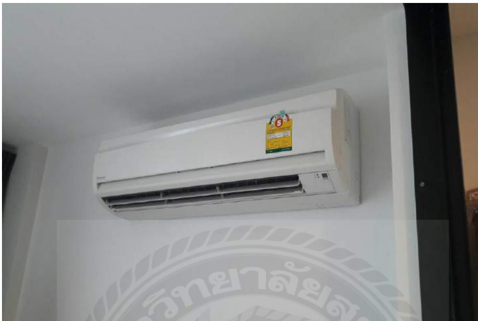
รูปที่ 3.7.4 เปิดเครื่องทำความเย็นตั้งแต่เวลา 08.00-16.00 น.
