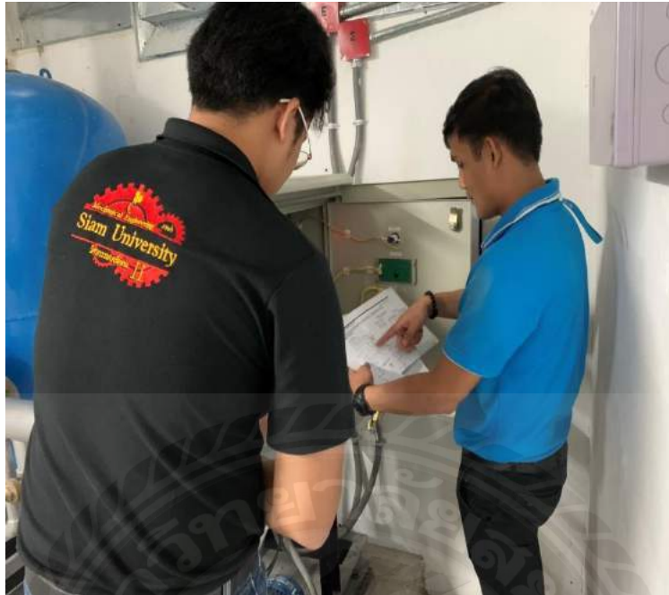
รูปที่ 3.7.2 พนักงานที่ปรึกษาอธิบายการทำงานของระบบปั๊มเพิ่มแรงดัน
