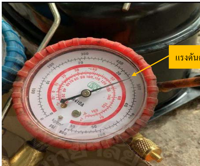
รูปที่ 3.8.1.7 ตรวจสอบแรงดันด้านอัด
