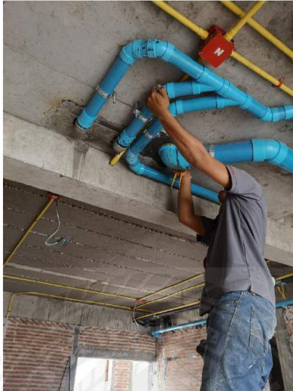
รูปที่ 7 การแก้ไขน้ำซึมรอบท่อ
