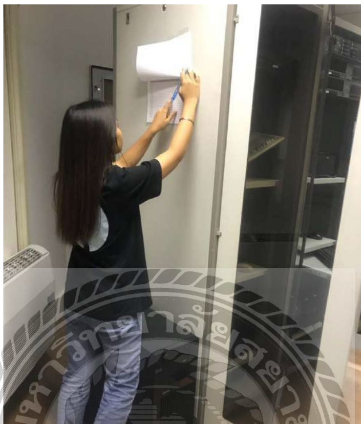
รูปที่ ค.7 ตรวจสอบห้องเซิร์ฟเวอร์
