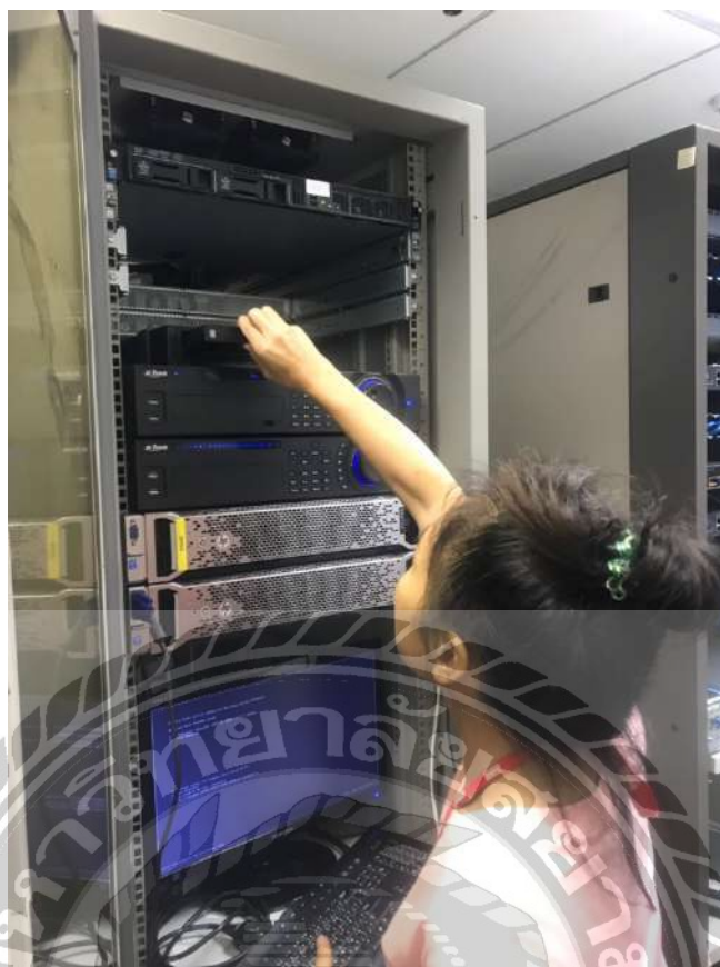
รูปที่ ค.8 เปลี่ยนเทป Backup ในห้องเซิร์ฟเวอร์ตอนต้นสัปดาห์
