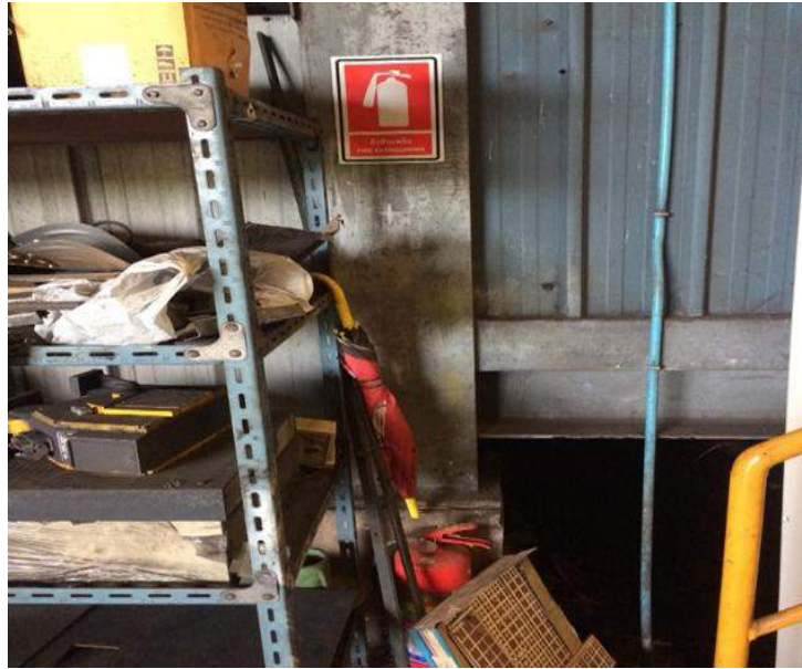
รูปที่ 4.6 จุดติดตั้งถังดับเพลิงเก่า
