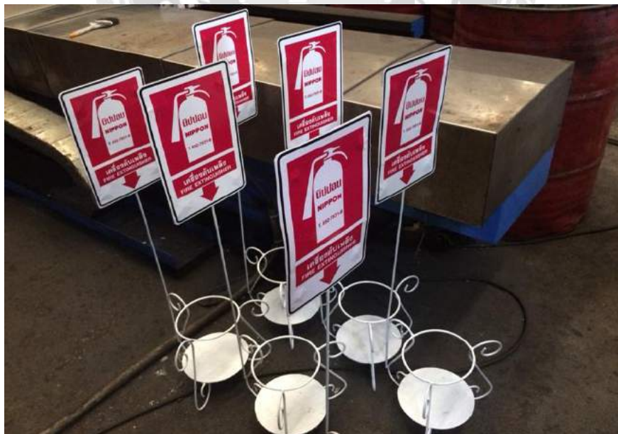
รูปที่ 4.1 จัดเตรียมฐานติดตั้งถังดับเพลิง
