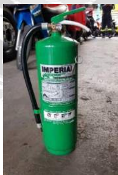
รูปภาพที่2.3ถังดับเพลิงชนิดBF2000
