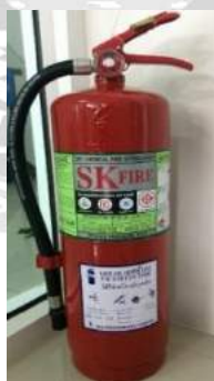
รูปภาพที่ 2.1 ถังดับเพลิงชนิดผงเคมีแห้ง
