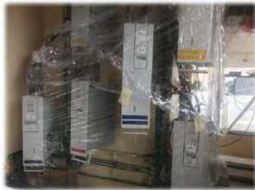
รูปที่ 4.7 อุปกรณ์สื่อสาร RRU
