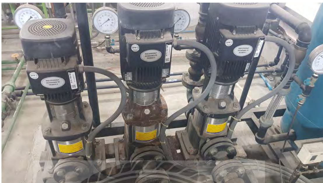
รูปที่ 6.19 มอเตอร์ปั้มน้ำ (Booster Pump) ที่นำน้ำรวมที่จุดติดตั้ง N1
