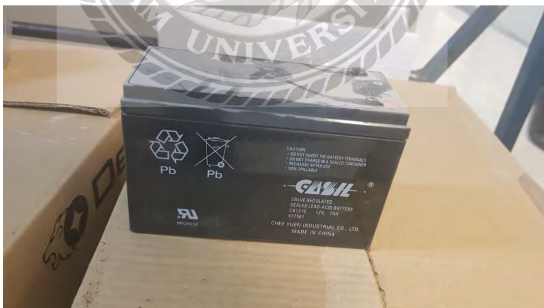
รูปที่ 6.30 แบตเตอรี่ของ Access Control System ที่เสื่อมสภาพ
