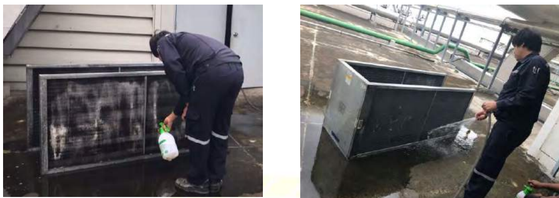
รูปที่ 4.4 การทำความสะอาดชุดลดความชื้นด้วยฮีทไปป์ (Heat Pipe)
