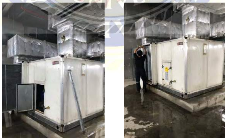
รูปที่ 2.10 Air Handling Unit
