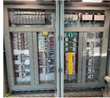
ภาพที่ 4 ตู้ควบคุมที่ใช้สำหรับระบบศูนย์ข้อมูล
