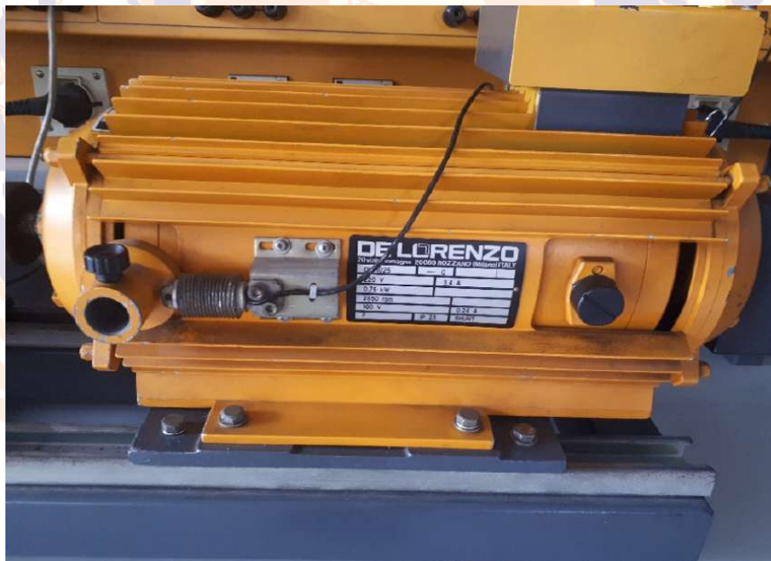
รูปที่ 4.5 Electric Generator
