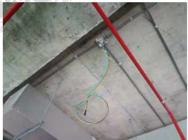
รูปที่3.5 กล่องพักสายไฟ ( Junction Box )
