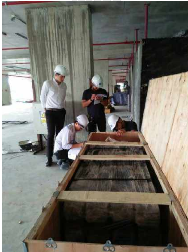
รูปที่ 4.8 การตรวจสอบเช็คตู้สวิตช์เกียร์
