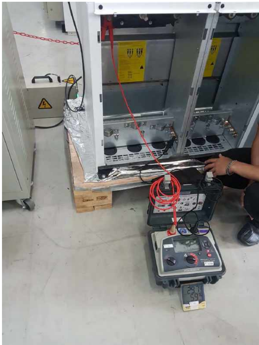
รูปที่ 4.3 ตรวจสอบเซ็คอุปกรณ์ภายในตู้สวิตช์เกียร์
