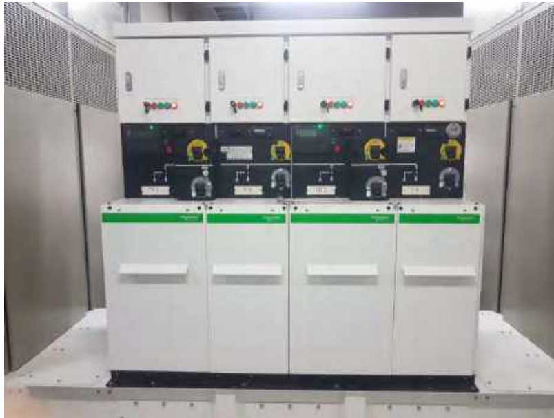
รูปที่ 4.30 สวิตช์เกียร์ไฟฟ้าแรงดันปานกลาง (RM6)
