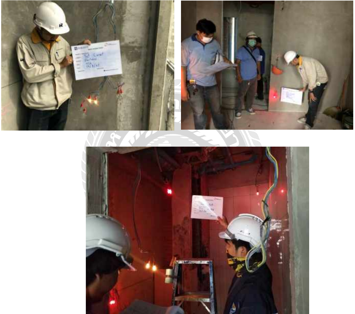
รูปที่ 4.7 การ Test Circuit ปลั๊กและโคมไฟ
