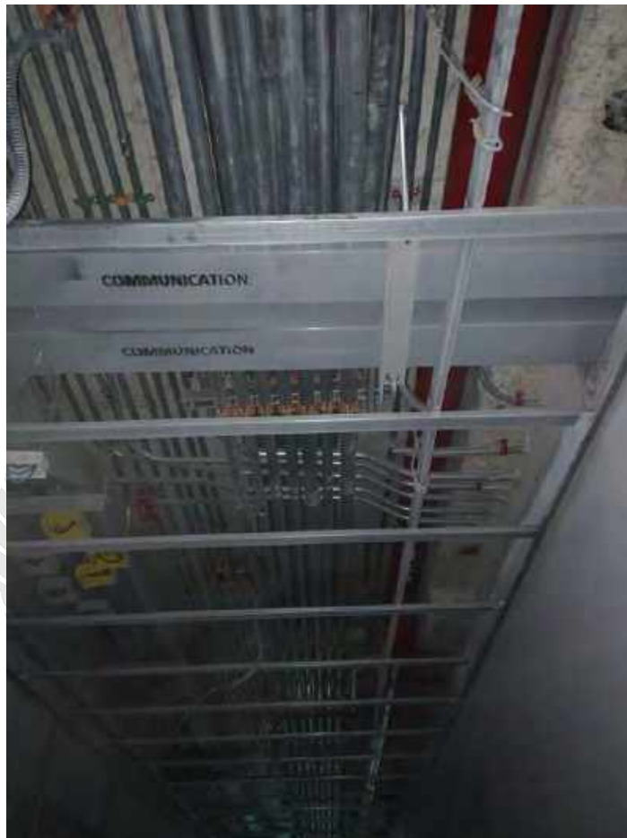
รูปที่ 4.9 ตรวจการเดินท่อไฟทางเดินส่วนกลาง
